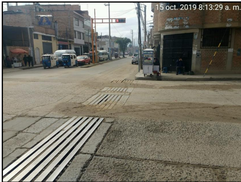
Figura 39. Cruceos peatonales en mal estado.
