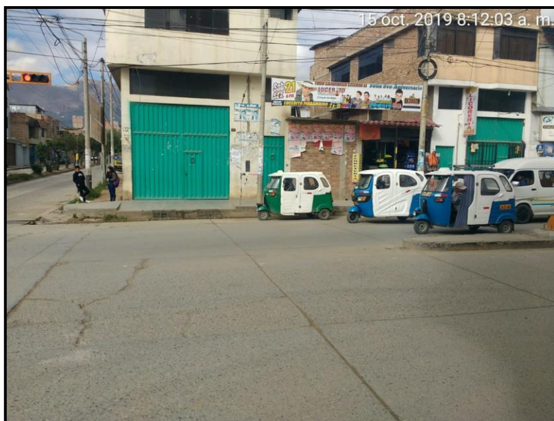
Figura 40. El espacio para peatones no cuenta con señalización.
