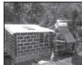
Imagen 2 Colector solar de tubos al vacío
