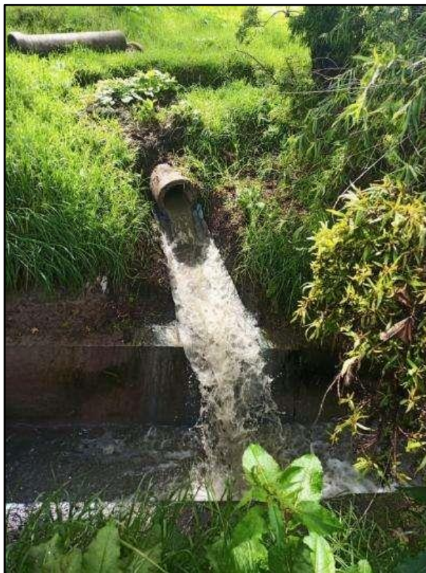
Imagen 76: PTAR Cajamarca deposita sus aguas grises al canal. La PTAR Cajamarca deposita aguas grises al canal la collpa.
