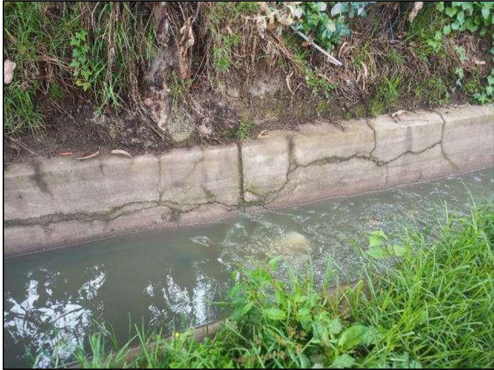
Imagen 20: Rotura de concreto simple. En varios tramos del canal se presentan fisuras de concreto como se puede apreciar en la imagen, por la falta de operación y mantenimiento.
