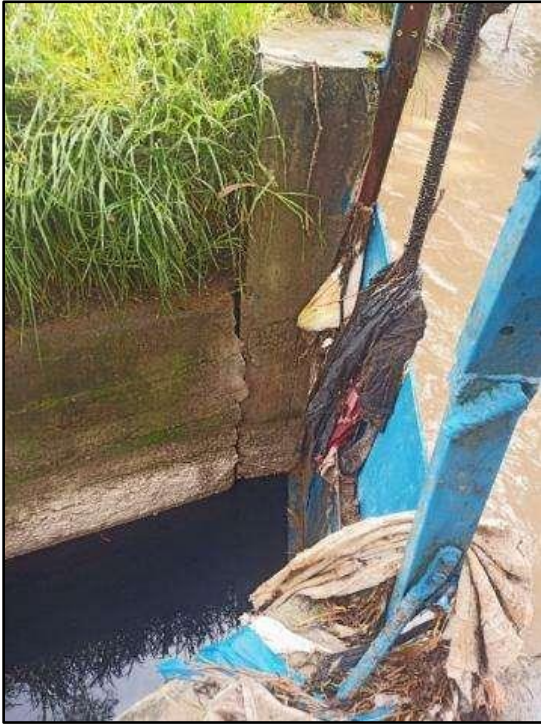
Imagen 09: Fisuras en bocatoma del canal.
