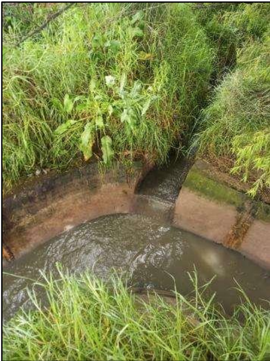
Imagen 11: Ingreso de aguas grises al canal.
