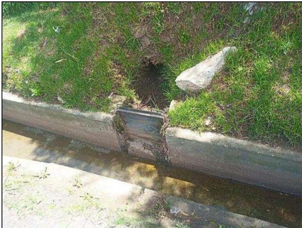
Imagen 70: Compuerta tipo tarjeta en mal estado Se muestra la compuerta de hierro tipo tarjeta; la cual controla el curso del agua.
