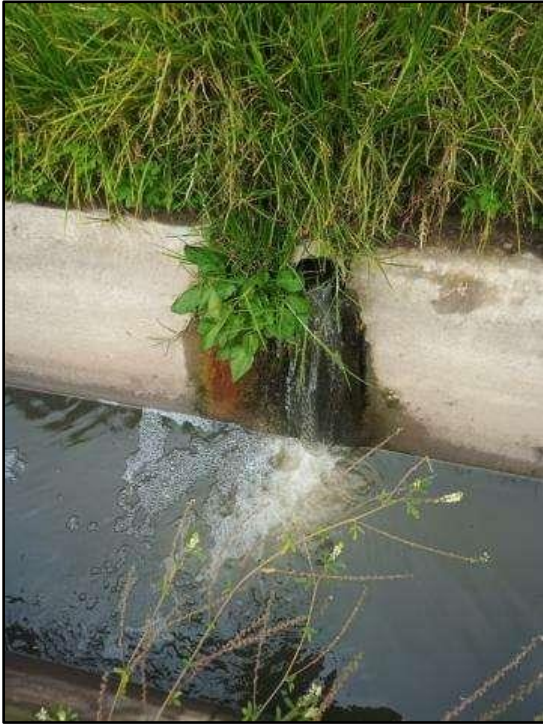
Imagen 13: Ingreso de aguas grises al canal.
