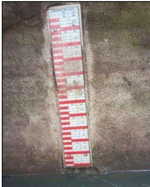
Imagen 65: Medidor de caudal en el tramo inicial del canal la Collpa
