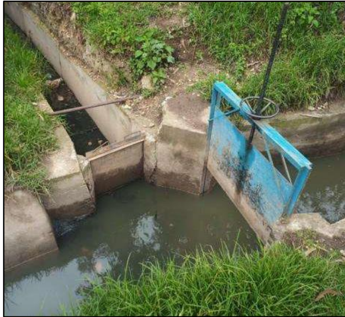
Imagen 66: Tomas laterales de concreto simple en el canal la Collpa Se muestra una toma lateral de sección rectangular, una compuerta de hierro tipo tarjeta en malas condiciones; la cual sirve para controlar el paso del agua.
