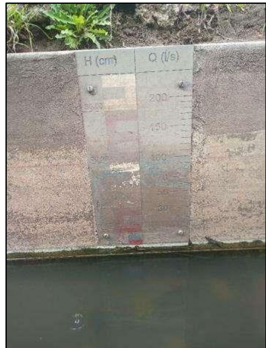
Imagen 22: Medidor de Caudal
