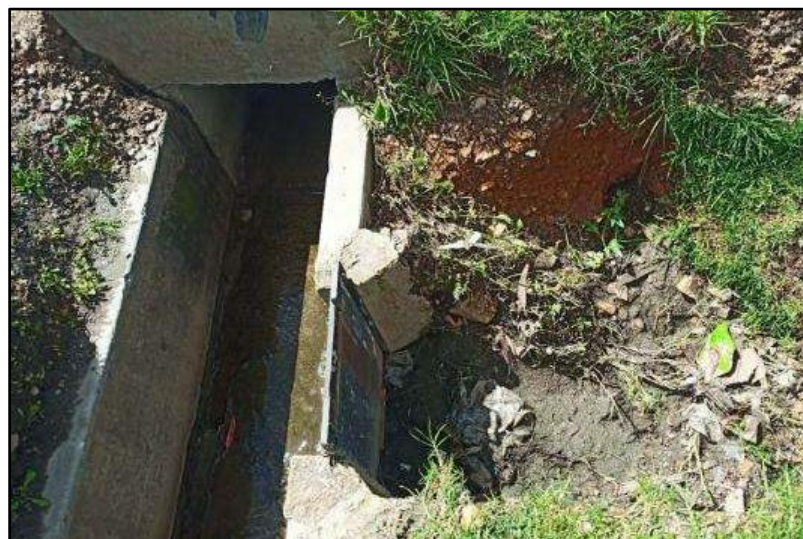
Imagen 67: Tomas laterales en tramos sin revestir del canal la Collpa Se muestra una toma lateral sin revestir, una compuerta de hierro tipo tarjeta en mal estado; la cual sirve para controlar el paso del agua.
