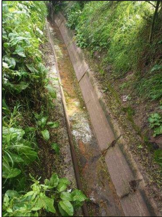
Imagen 32: Tramo inicial del canal la Collpa (Épocas de lluvia) El tramo inicial del canal es de sección trapezoidal el cual se encuentra con presencia de aguas residuales procedentes de la PTAR Cajamarca.
