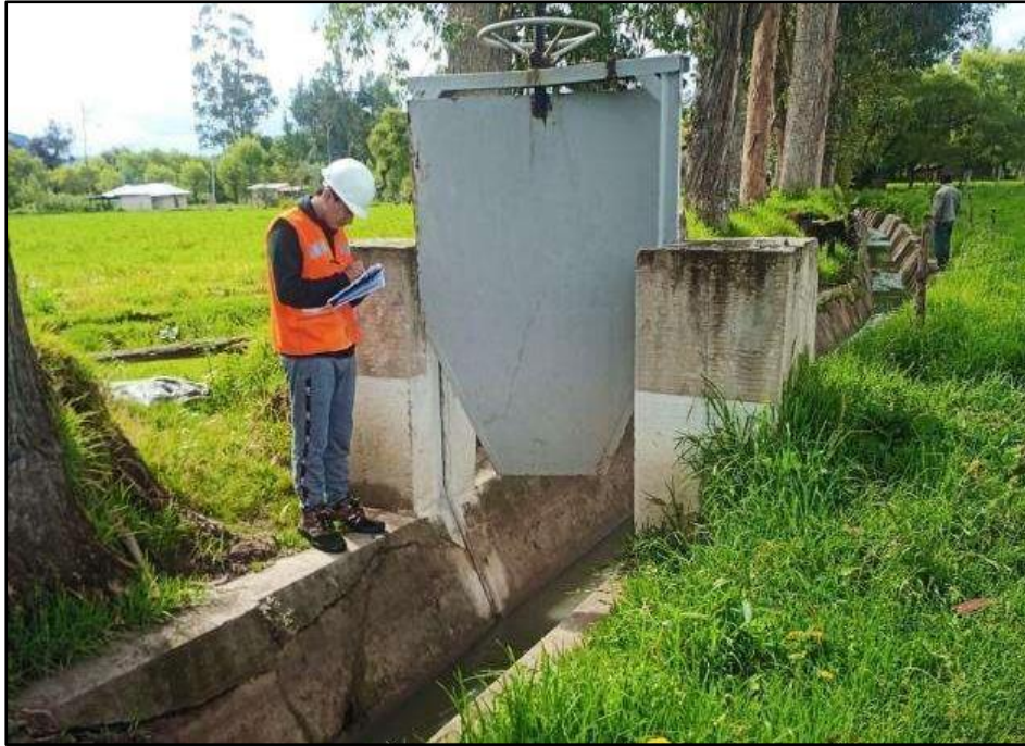
Imagen 69: Compuerta tipo gusano Se muestra la compuerta de hierro tipo gusano; la cual controla el curso del agua.
