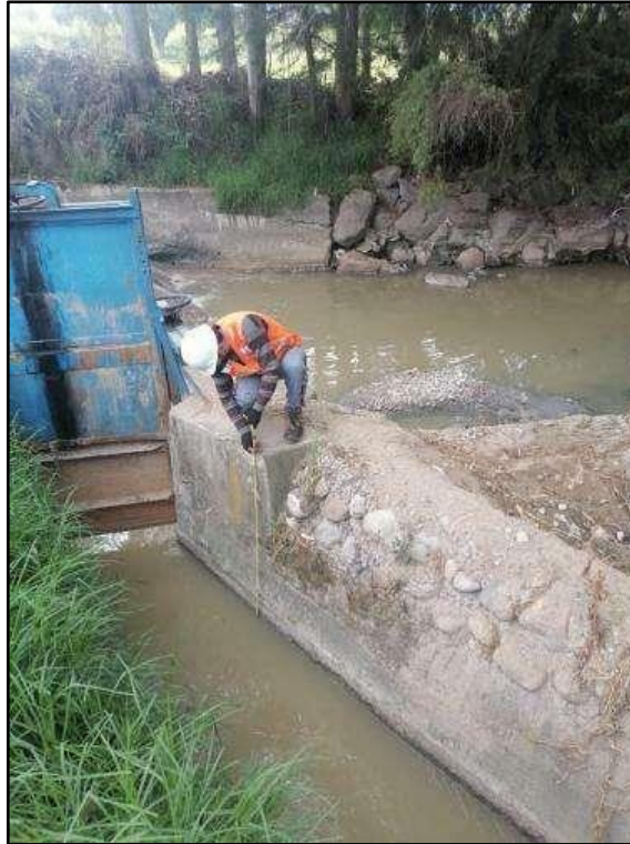
Imagen 18: Mediciones de la estructura de la bocatoma. Se muestra una imagen realizando la toma de datos de bocatoma.
