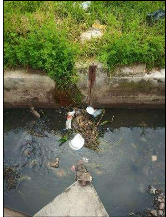
Imagen 30: Compuerta en mal estado.
