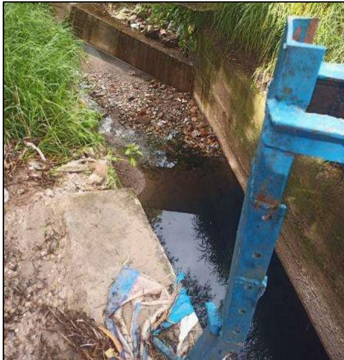
Imagen 22: Estanque disipador en máximas avenidas El estanque disipador se encuentra posterior a la bocatoma, con falta de mantenimiento y en mal estado.
