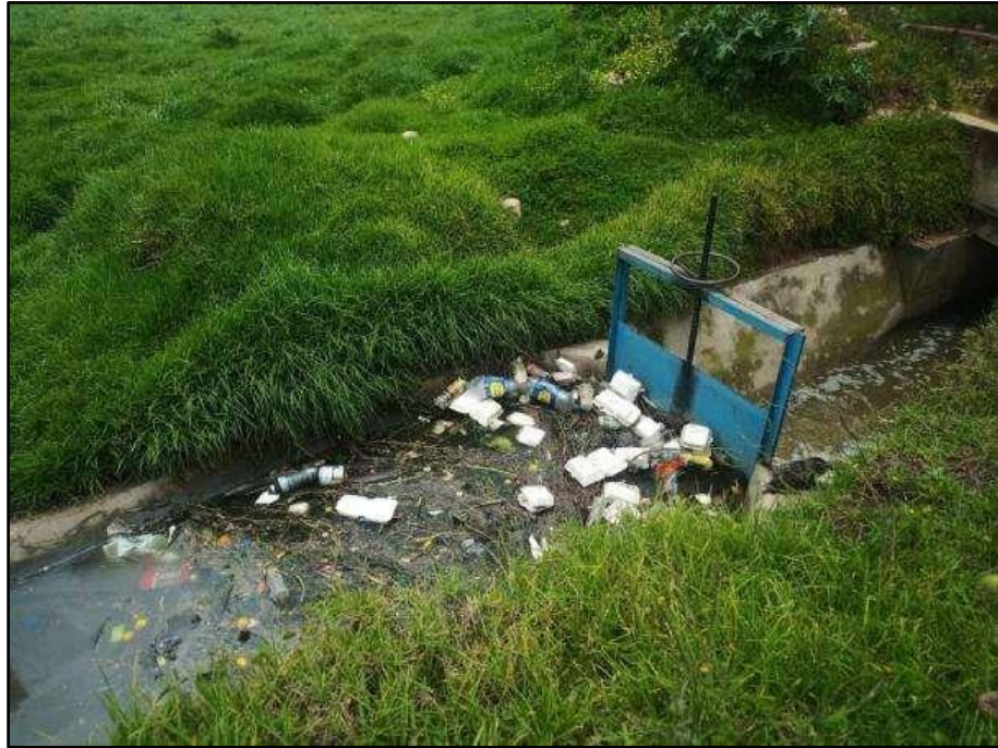
Imagen 47: Canal de derivación principal con presencia de basura. Como se puede apreciar en la imagen, el canal tiene basura en su curso, con presencia de botellas, plásticos, yerbas y lodo el cual dificulta al curso del agua.
