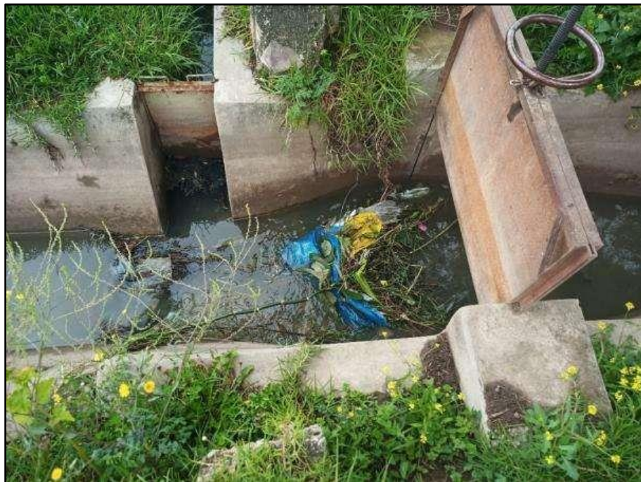
Imagen 42: Punto de inicio de Canal lateral de Primero orden N° 02 En este punto se tiene el primer canal lateral de primer orden N° 02
