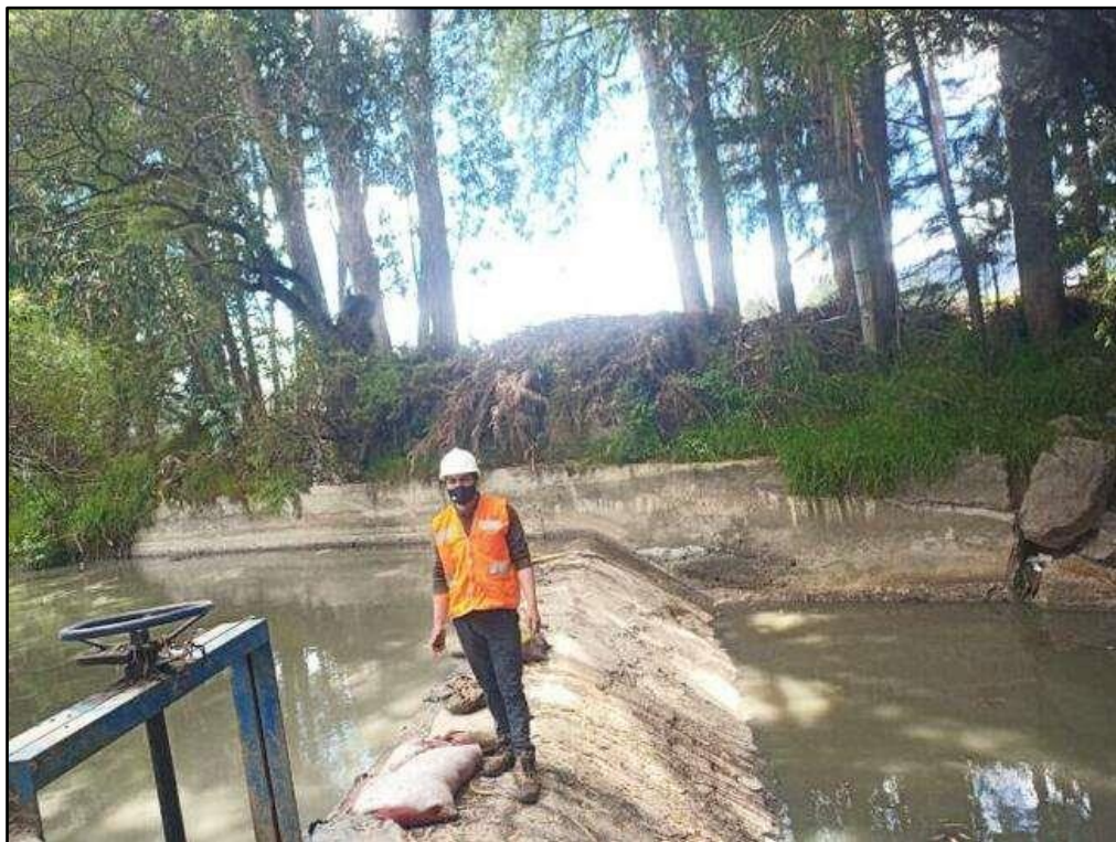
Imagen 06: Barraje del canal la Collpa en épocas de estiaje, en donde se aprecia los costales de arena que se han colocado para tener una mejor captación de caudal.
