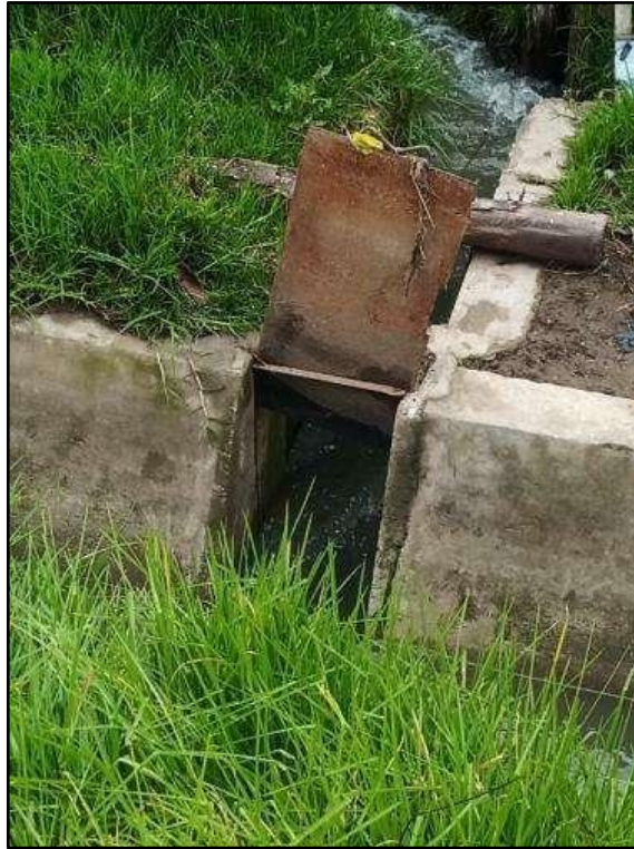
Imagen 79: Compuerta en mal estado.
