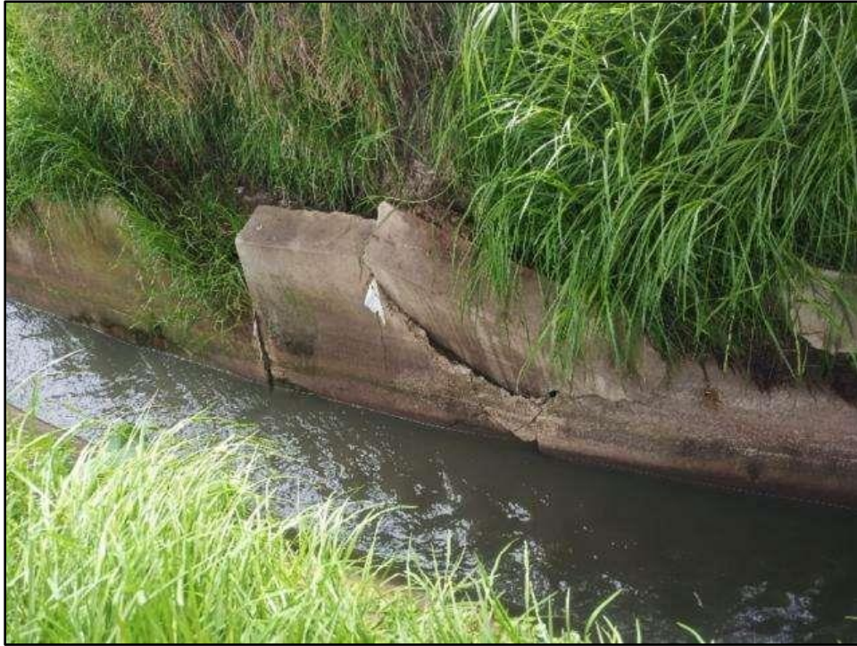
Imagen 17: Rotura de concreto simple.
