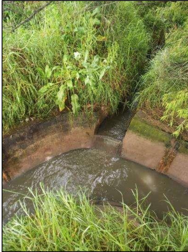
Imagen 77: PTAR Cajamarca deposita sus aguas grises al canal. La PTAR Cajamarca deposita aguas grises al canal la collpa.
