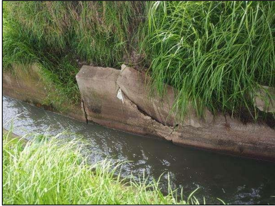
Imagen 37: Rotura de concreto
