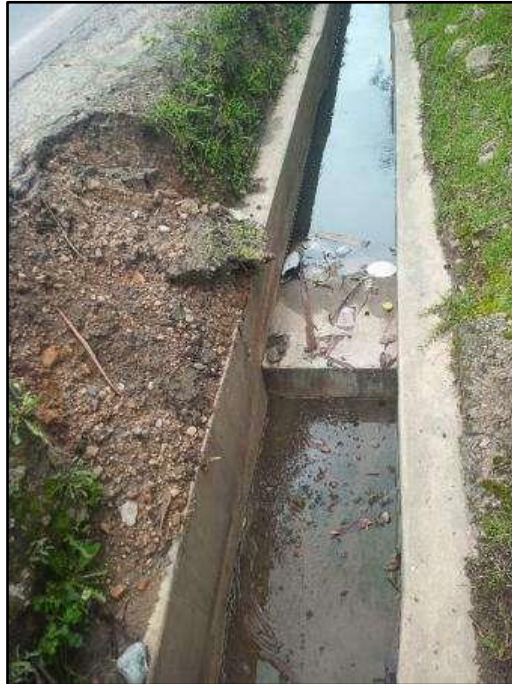
Imagen 74: Caídas en el canal la Collpa. Se muestra una caída en un tramo del canal la Collpa.
