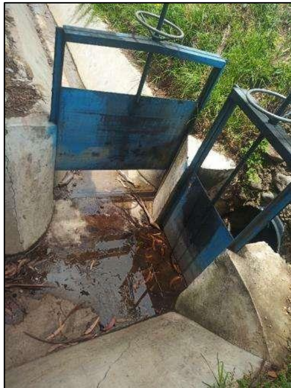
Imagen 49: Punto final del canal principal de derivación. Punto final del canal principal de derivación.
