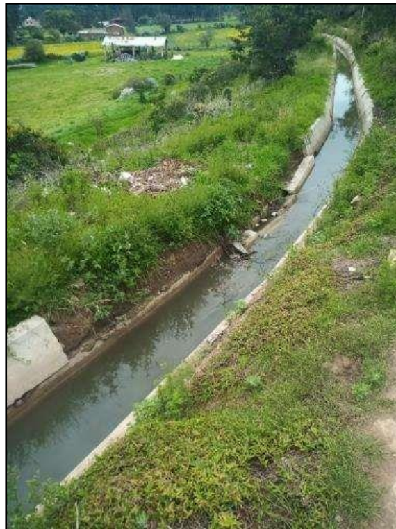
Imagen 80: Degradación y rotura de concreto.
