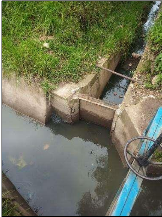
Imagen 44: Punto de inicio de Canal lateral de Primero orden N° 03 En este punto se tiene el primer canal lateral de primer orden N° 03
