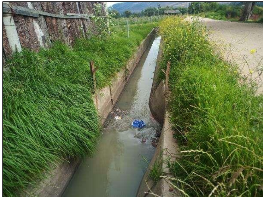
Imagen 55: Tramo del canal lateral de primer orden N° 02 con presencia de lodo. Tramo del canal lateral de primer orden N° 02, paralelo a la carretera La Paccha con presencia de lodo y falta de mantenimiento en algunos tramos.
