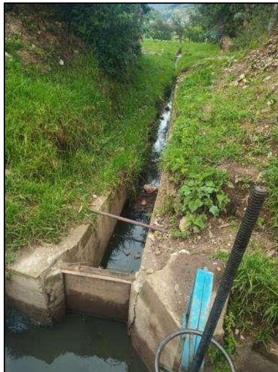
Imagen 56: Sección del tramo del canal lateral de primer orden N° 03. Tramo del canal lateral de primer orden N° 03, se sección rectangular, cuya compuerta se encuentra en mal estado con presencia de oxido y con fugas de agua en este punto.
