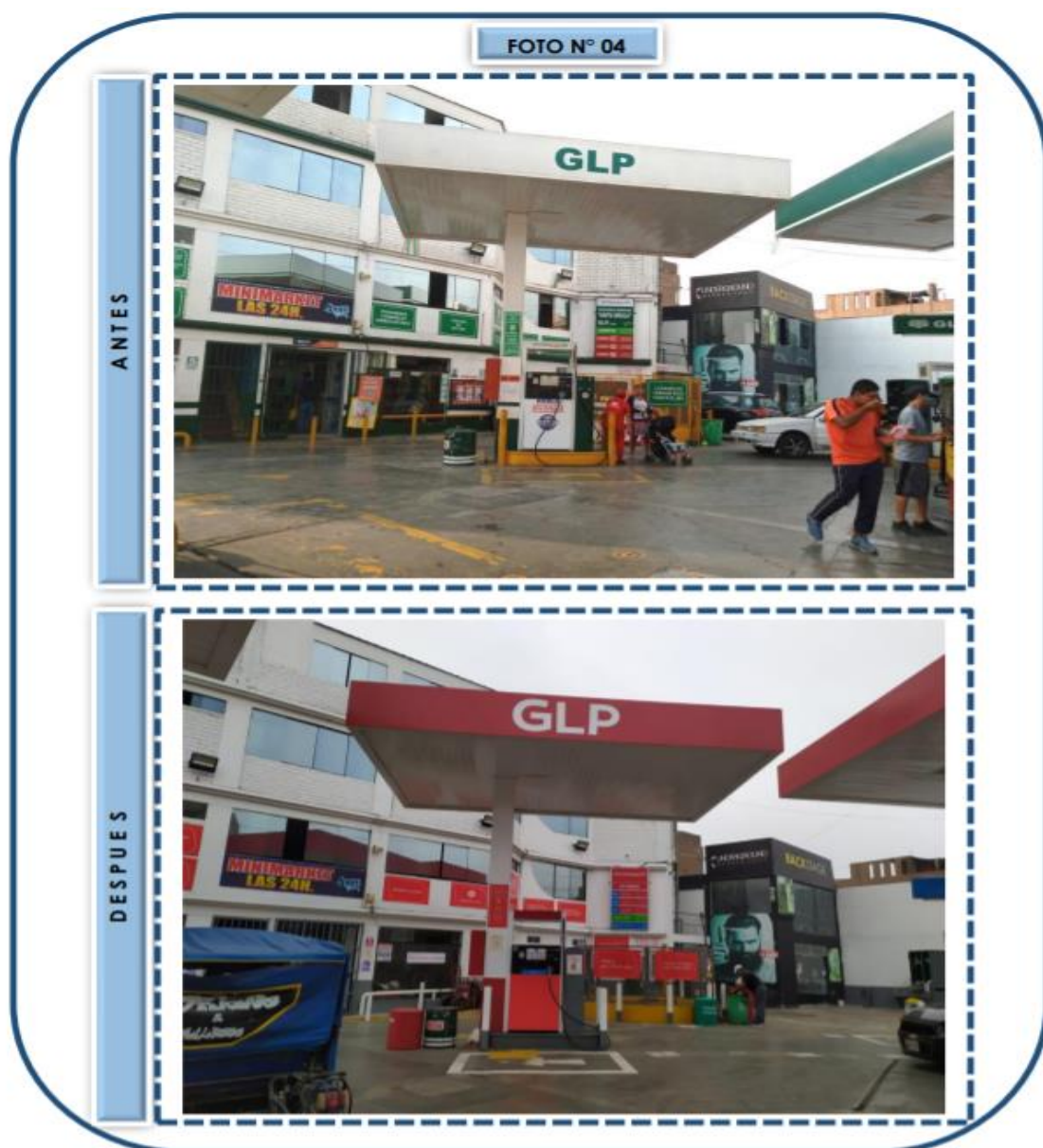
Figura 34: Antes y después de los trabajos de pintura realizados en el canopy Fuente: Empresa
