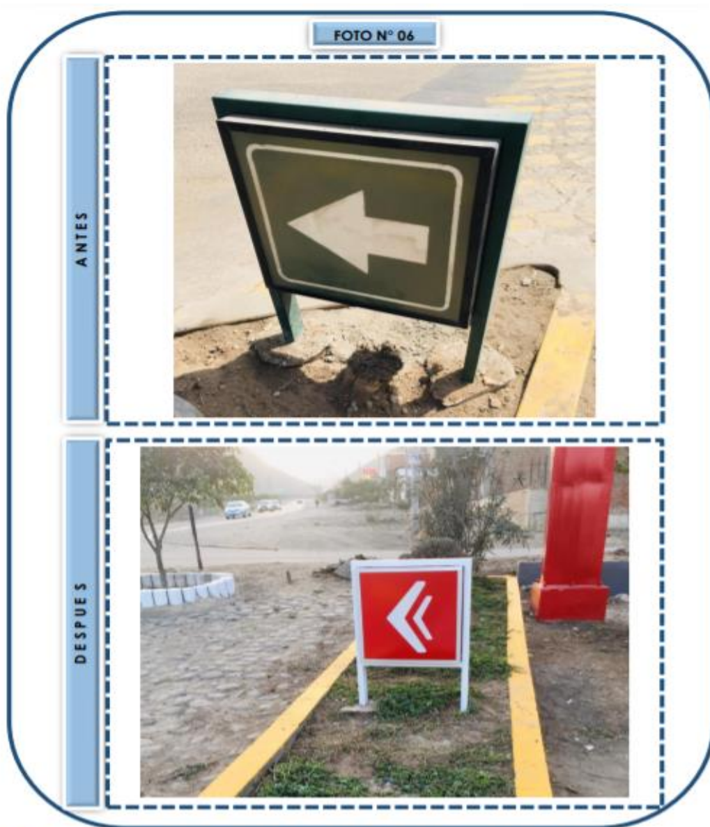
Figura 36: Antes y después de los trabajos de mantenimiento de bienes publicitarios Fuente: Empresa
