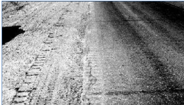
Figura 60. Agrietamiento de reflexión de junta – baja severidad Fuente: Norma Técnica ASTM D6433-03 (2004)
