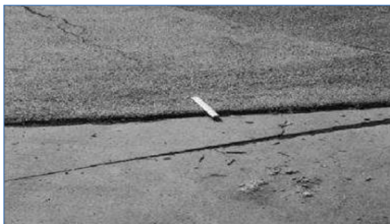
Figura 82. Desplazamiento – mediana severidad Fuente: Norma Técnica ASTM D6433-03 (2004)
