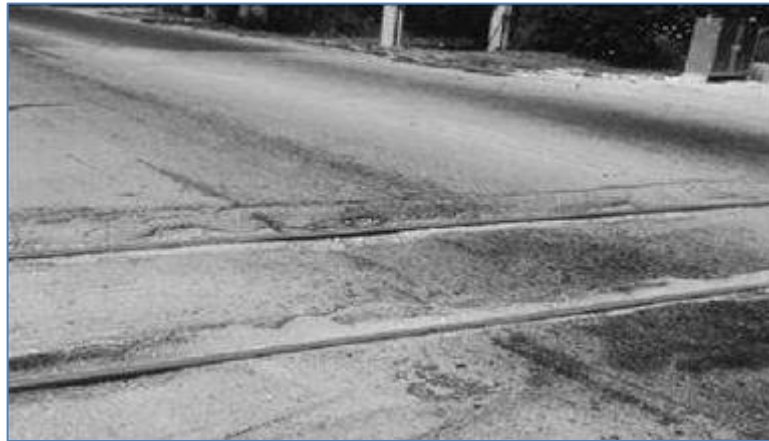
Figura 86. Cruce vía férrea – mediana severidad Fuente: Norma Técnica ASTM D6433-03 (2004)
