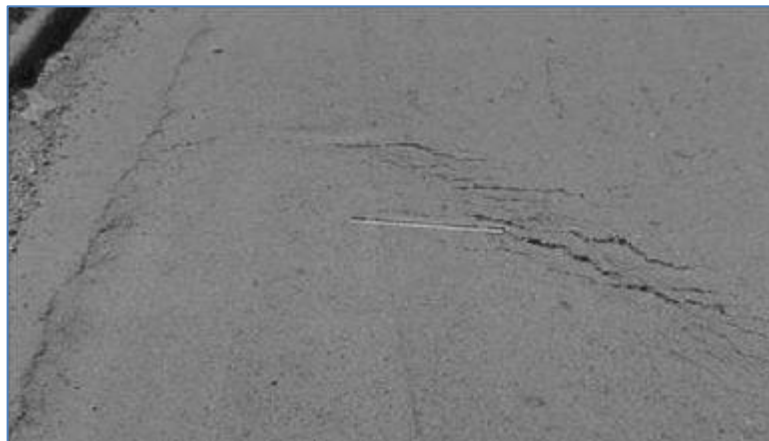
Figura 67. Fisura parabólica o por deslizamiento – mediana severidad Fuente: Norma Técnica ASTM D6433-03 (2004)
