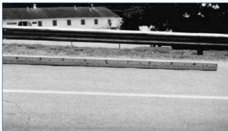
Figura 72. Corrugación – baja severidad Fuente: Norma Técnica ASTM D6433-03 (2004)
