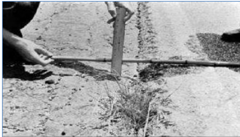
Figura 99. Desnivel carril – berma – mediana severidad
