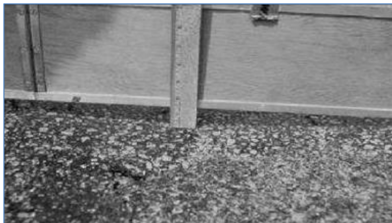
Figura 80. Ahuellamiento – alta severidad Fuente: Norma Técnica ASTM D6433-03 (2004)
