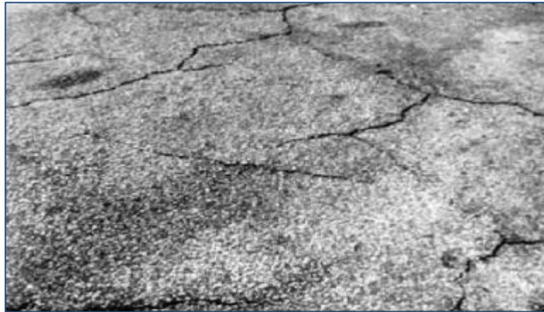
Figura 56. Agrietamiento en bloque – alta severidad Fuente: Norma Técnica ASTM D6433-03 (2004)
