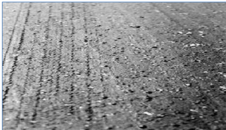
Figura 96. Exudación – alta severidad Fuente: Norma Técnica ASTM D6433-03 (2004)
