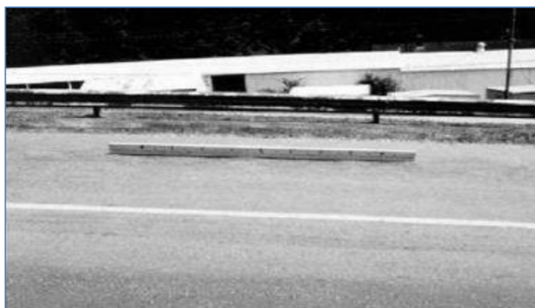
Figura 73. Corrugación – mediana severidad Fuente: Norma Técnica ASTM D6433-03 (2004)
