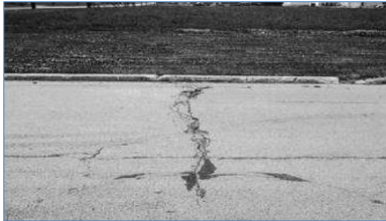
Figura 65. Longitudinales y transversales – alta severidad Fuente: Norma Técnica ASTM D6433-03 (2004)
