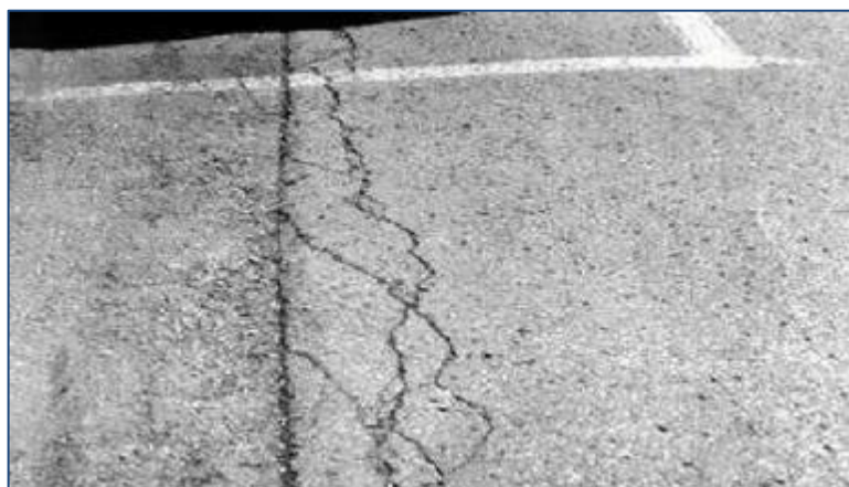
Figura 58. Agrietamiento de borde – mediana severidad Fuente: Norma Técnica ASTM D6433-03 (2004)
