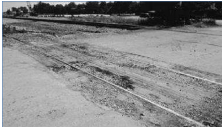
Figura 87. Cruce vía férrea – alta severidad Fuente: Norma Técnica ASTM D6433-03 (2004)
