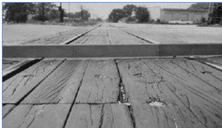
Figura 85. Cruce vía férrea – baja severidad Fuente: Norma Técnica ASTM D6433-03 (2004)
