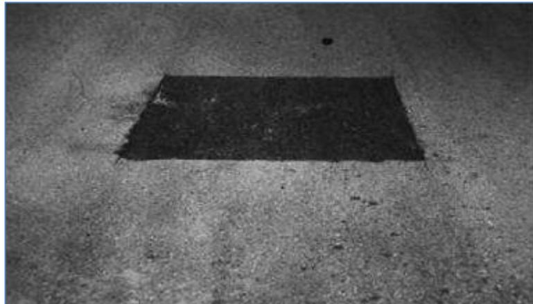
Figura 101. Parches – baja severidad Fuente: Norma Técnica ASTM D6433-03 (2004)
