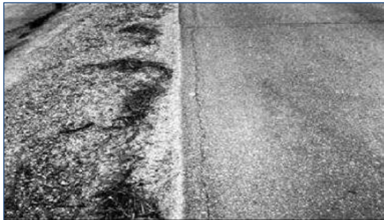
Figura 57. Agrietamiento de borde – baja severidad Fuente: Norma Técnica ASTM D6433-03 (2004)
