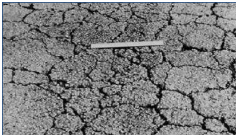
Figura 53. Piel de cocodrilo – alta severidad Fuente: Norma Técnica ASTM D6433-03 (2004)
