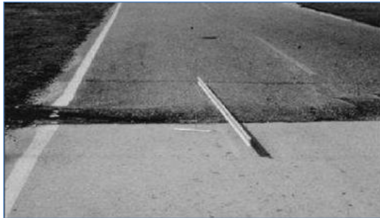
Figura 66. Fisura parabólica o por deslizamiento – baja severidad Fuente: Norma Técnica ASTM D6433-03 (2004)
