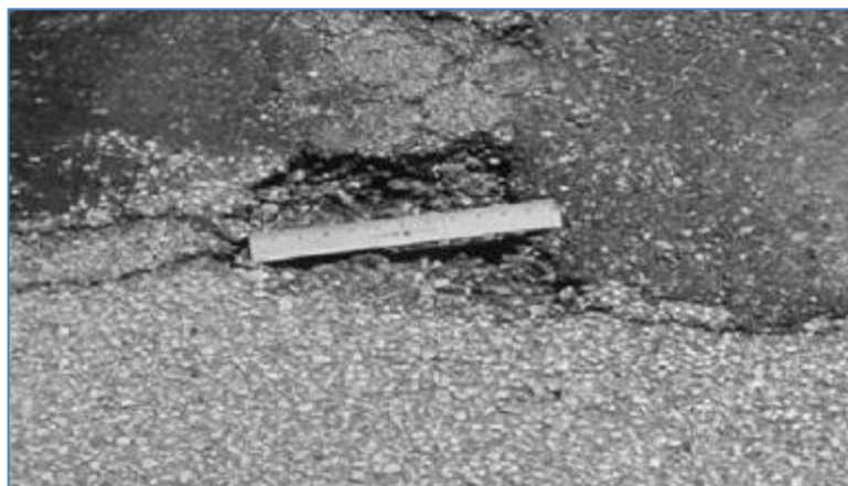
Figura 88. Baches (huecos) – baja severidad Fuente: Norma Técnica ASTM D6433-03 (2004)
