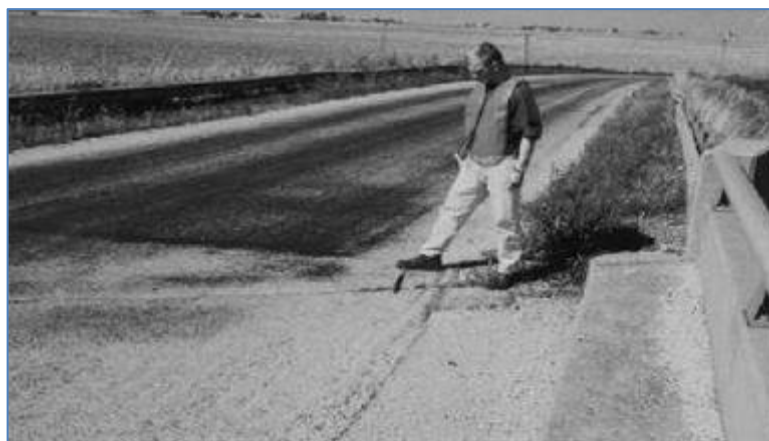
Figura 81. Desplazamiento – baja severidad Fuente: Norma Técnica ASTM D6433-03 (2004)
