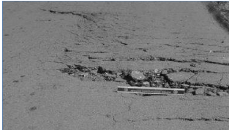
Figura 68. Fisura parabólica o por deslizamiento – alta severidad Fuente: Norma Técnica ASTM D6433-03 (2004)
