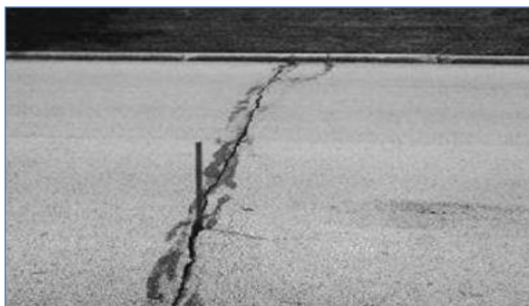
Figura 64. Longitudinales y transversales – mediana severidad Fuente: Norma Técnica ASTM D6433-03 (2004)
