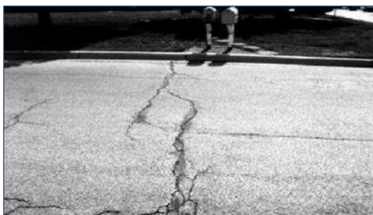
Figura 55. Agrietamiento en bloque – mediana severidad Fuente: Norma Técnica ASTM D6433-03 (2004)
