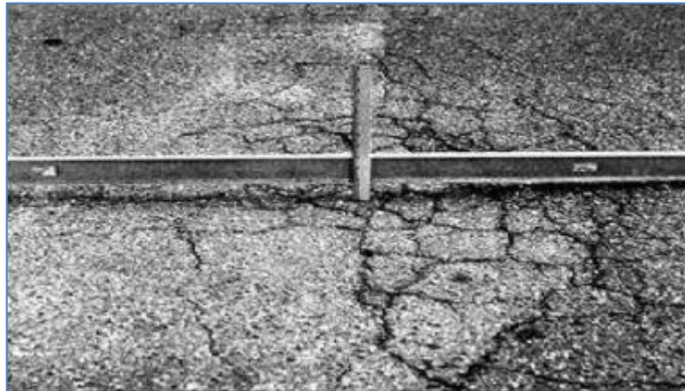
Figura 77. Depresión – alta severidad Fuente: Norma Técnica ASTM D6433-03 (2004)
