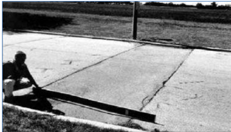
Figura 102. Parches – mediana severidad Fuente: Norma Técnica ASTM D6433-03 (2004)
