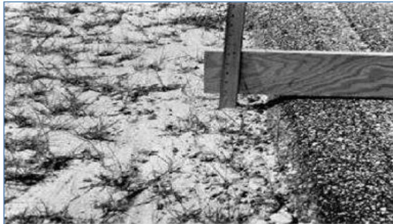
Figura 98. Desnivel carril – berma – baja severidad
