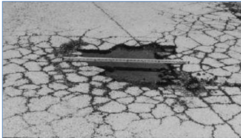
Figura 90. Baches (huecos) – alta severidad Fuente: Norma Técnica ASTM D6433-03 (2004)
