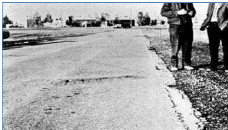
Figura 70. Abultamientos y hundimientos – mediana severidad Fuente: Norma Técnica ASTM D6433-03 (2004)
