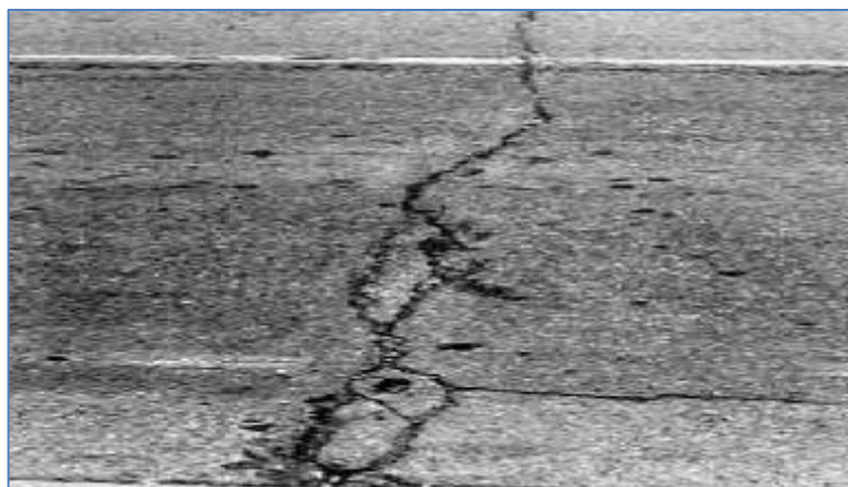
Figura 61. Agrietamiento de reflexión de junta – mediana severidad Fuente: Norma Técnica ASTM D6433-03 (2004)
