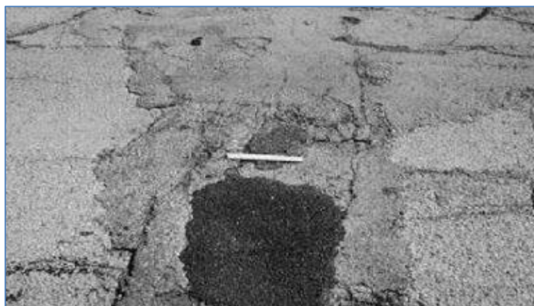
Figura 103. Parches – alta severidad Fuente: Norma Técnica ASTM D6433-03 (2004)
