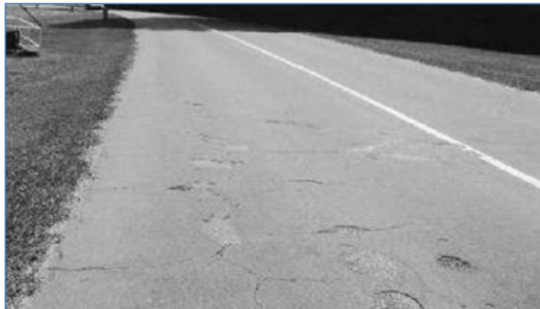
Figura 93. Peladura por intemperismo y desprendimiento de agregados – alta severidad
