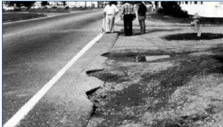
Figura 59. Agrietamiento de borde – alta severidad Fuente: Norma Técnica ASTM D6433-03 (2004)
