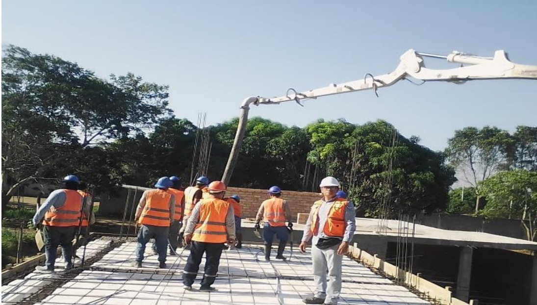
Figura 11. Charla sobre seguridad y vaciado de losa aligerada con concreto premezclado f_c = 210\text{kg/cm}^2
