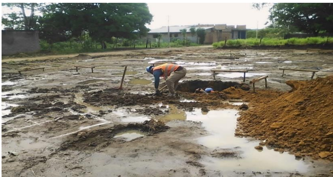
Figura 6. Condiciones del terreno luego de una lluvia
