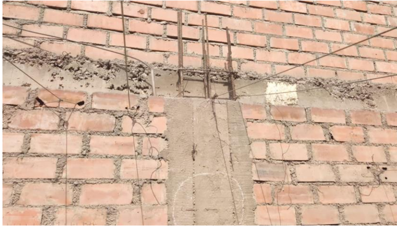
Figura N° 47 Muro portante no ligado
