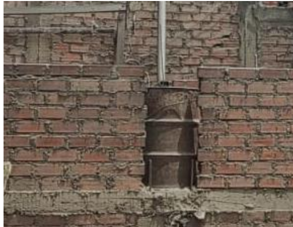
Figura N° 96 Parapetos no conectados
