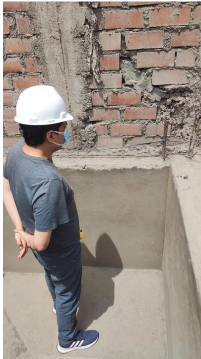
Figura N° 100 Elemento estructural en mal estado
