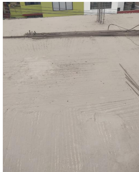
Figura N° 95 Inexistencia de parapetos
