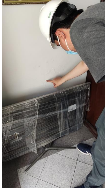
Figura N° 101 Fisuras en muro portante
