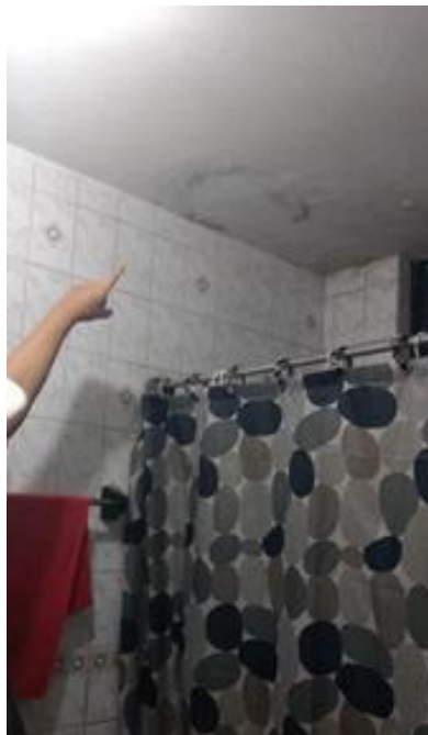
Figura N° 98 Elemento estructural dañado
