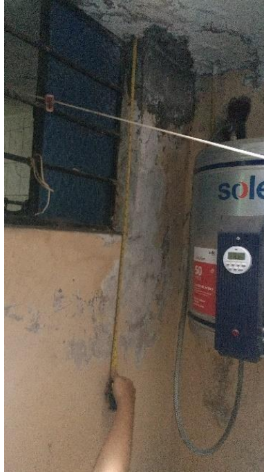
Figura N° 97 Daños en el muro por filtración
