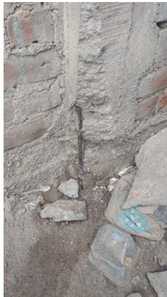
Figura N° 102 Columna en mal estado
