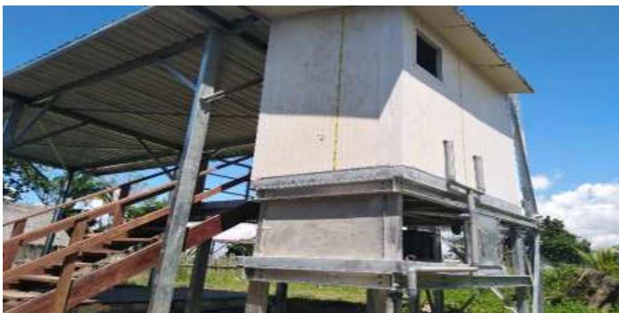
Figura 143 Instalación de acceso a desnivel de modulo UBS en la localidad de 13 de febrero
