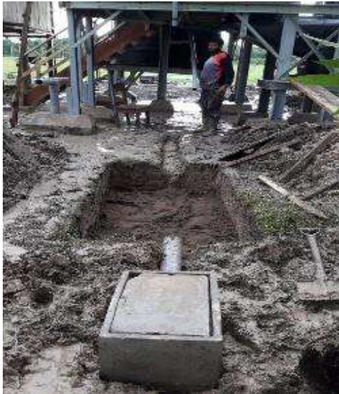
Figura 165 Instalación de caja de registro de aguas servidas de modulo UBS en la localidad de 13 de febrero Fuente: Elaboración propia
