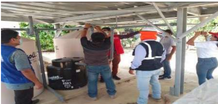
Figura 146 Instalaciones hidráulica módulo de captación de aguas pluviales.
