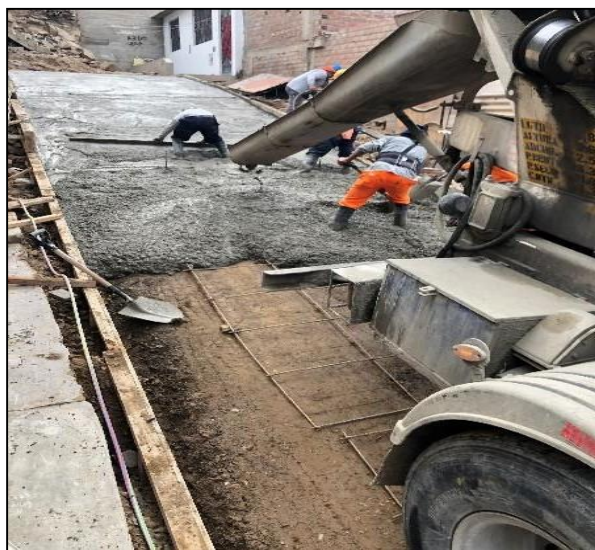
Figura 58 Llenado de veredas de concreto de 2.30 m en el pasaje 8 en el sector 3-Mz H3 Fuente elaboración propia
