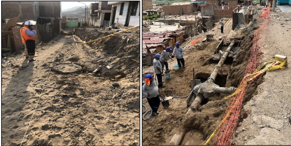
Figura 73 Problemas con las tuberías de desagüe que atravesaban los cimientos corridos de muro de contención en el Pasaje B, se decidió excavación manual y modificar el muro. Fuente elaboración propia
