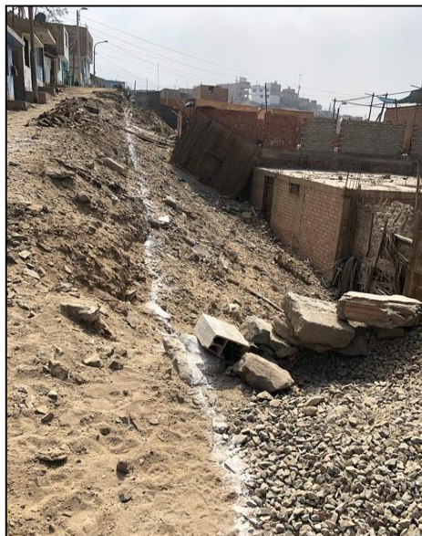
Figura 67 Trazo y replanteo de muro de contención en el Pasaje B Fuente elaboración propia
