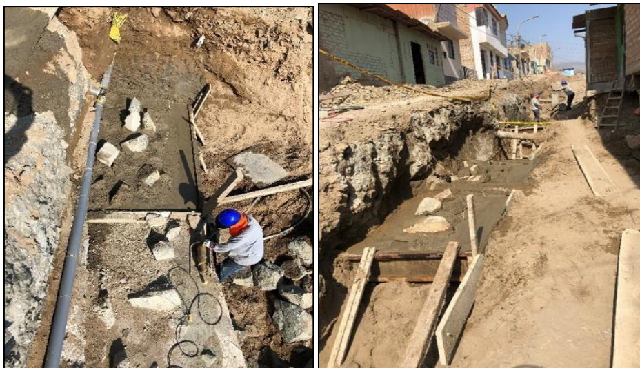
Figura 84 Llenado de cimiento corrido de muro de contención en el Pasaje 6 y Pasaje B Fuente elaboración propia
