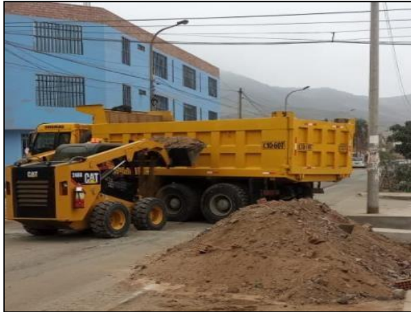
Figura 77 Eliminación de material excedente en una zona de acoplo con la ayuda del mini cargador y volquete
