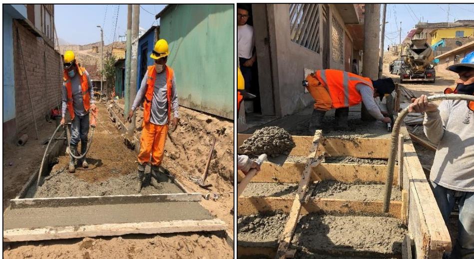
Figura 56 Utilización de vibradora de concreto en el sector 4-Mz I7 y el Sector 6-MZ Ñ6 Fuente elaboración propia
