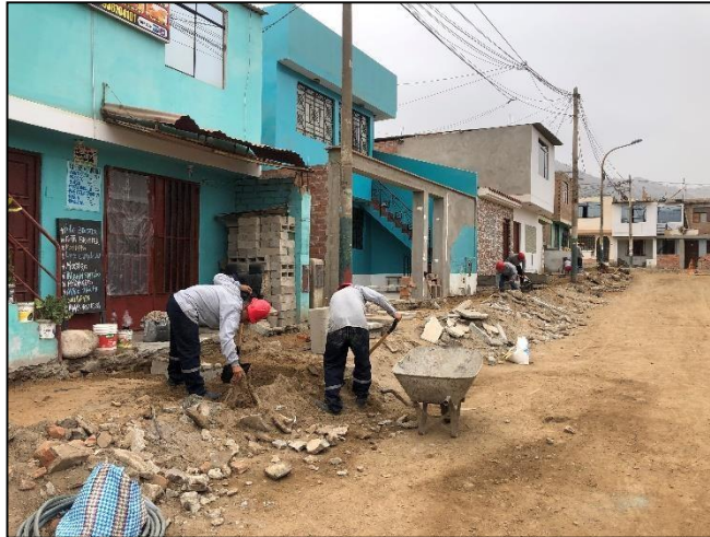
Figura 17 Excavación manual de veredas en el Sector 1-Mz G8 Fuente elaboración propia
