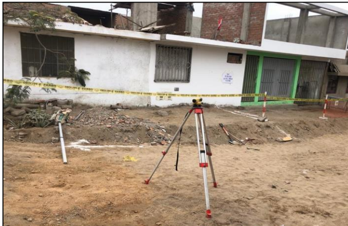
Figura 6 Equipo para realizar el trazo y replanteo en la Zona A del AA. HH Los Rosales Fuente Elaboración propia
