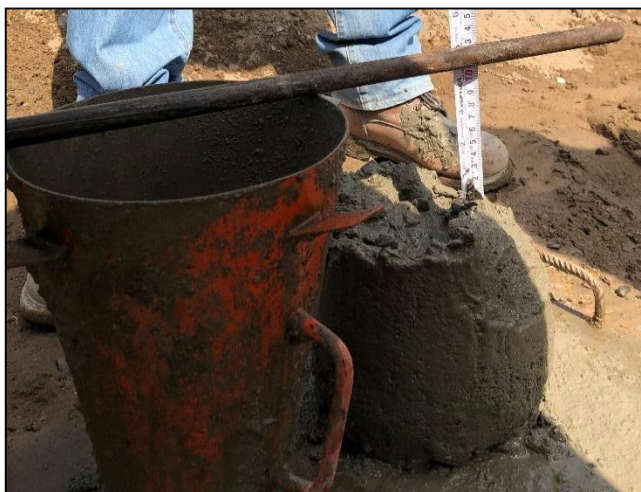
Figura 44 Medición con guincha del asentamiento de concreto que resulta ser de 4.5 pulgadas, para obra se pidió que el Slump sea de 4 a 6 pulgadas cumpliendo la concretara con lo solicitado.
