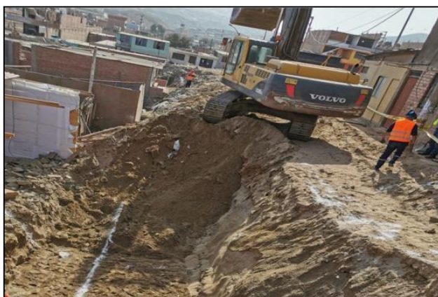
Figura 69 Corte de terreno normal con excavadora para muro de contención en el pasaje 7 Fuente elaboración propia
