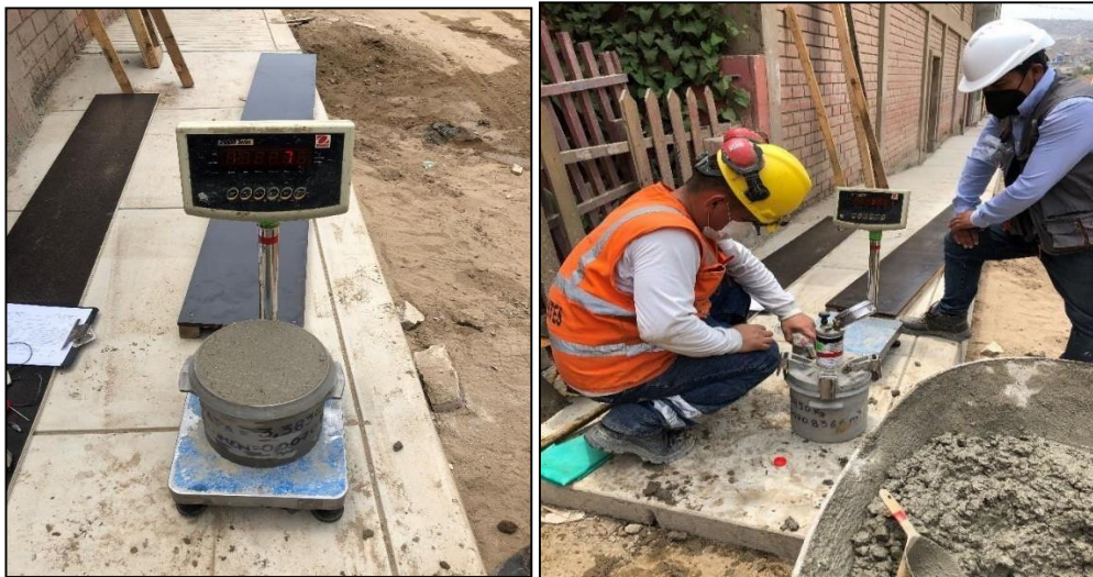
Figura 63 Prueba del peso unitario del concreto y prueba de contenido de aire del concreto con la supervisión.
