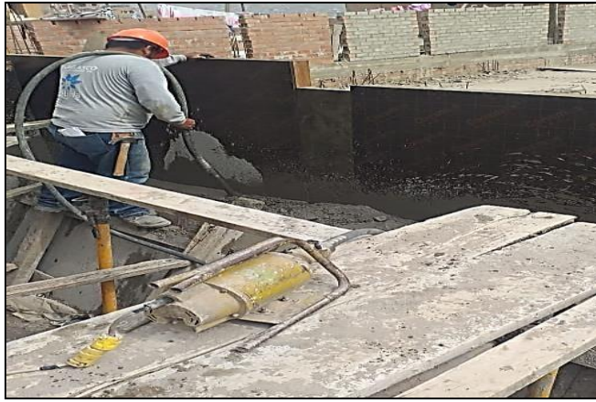
Figura 89 Utilización de vibradora de concreto para pantalla de muro de contención en el Pasaje B Fuente elaboración propia
