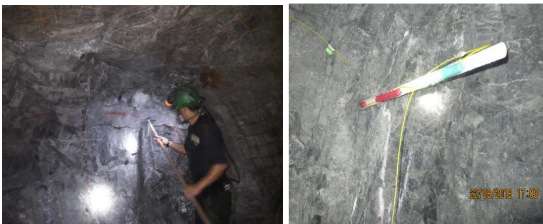
SE PROCEDE A CARGAR LOS TALADROS DE CORONA (USO DE CAÑAS DE PVC) EN LA RA IFTI (NV 2360)
