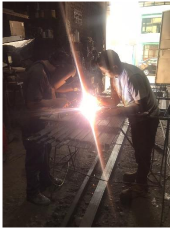
NO UTILIZA EPP Y USO INCORRECTO DE HERRAMIENTAS.
