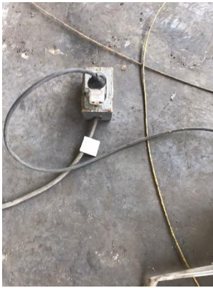
MALAS CONEXIONES ELECTRICAS.
