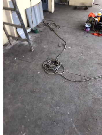
CABLES EN DESORDEN Y MALAS CONEXIONES.
