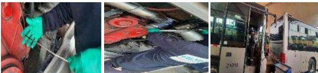
Figura 28. Implementación del nuevo proceso de microfiltración en las unidades
