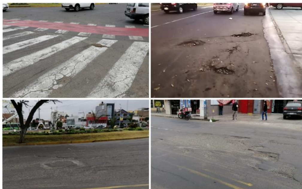
Figura 38. Fallas en el pavimento
