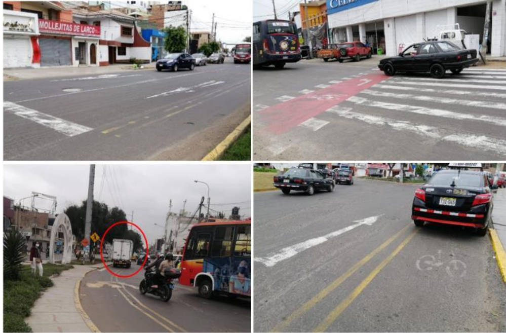
Figura 33. Deterioro de flechas direccionales, cruce de ciclista e invasión de línea doble
