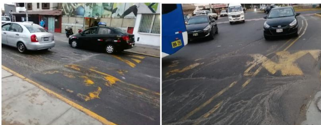
Figura 37. Gibas rompemuelle en mal estado
