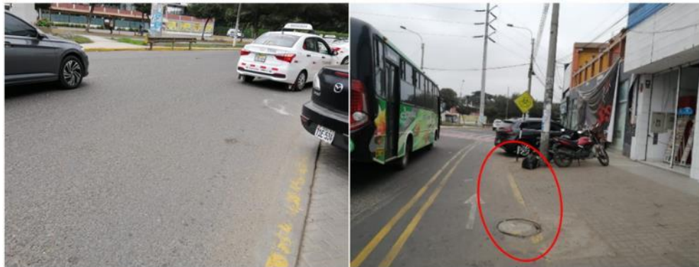
Figura 34. Pintura deteriorada para la restricción de estacionamiento
