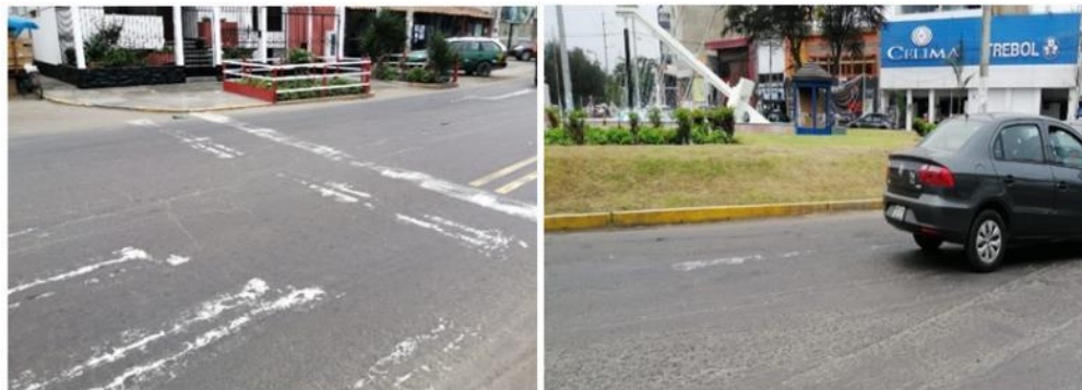
Figura 32. Líneas de carril, líneas de pare y paso de cebra en mal estado
