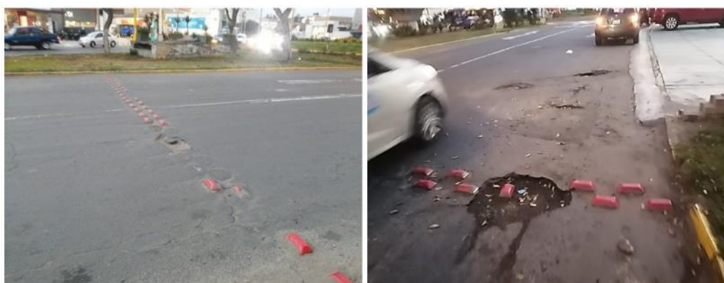
Figura 36. Tachas retrorreflectivas deterioradas
