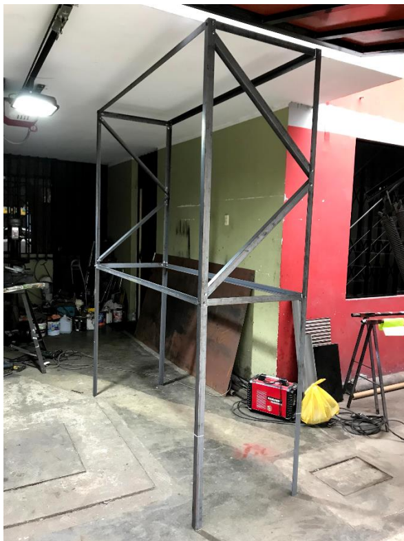
Figura 54. Realización de estructura y prueba de armado del diseño del captador prismático optimizado.
