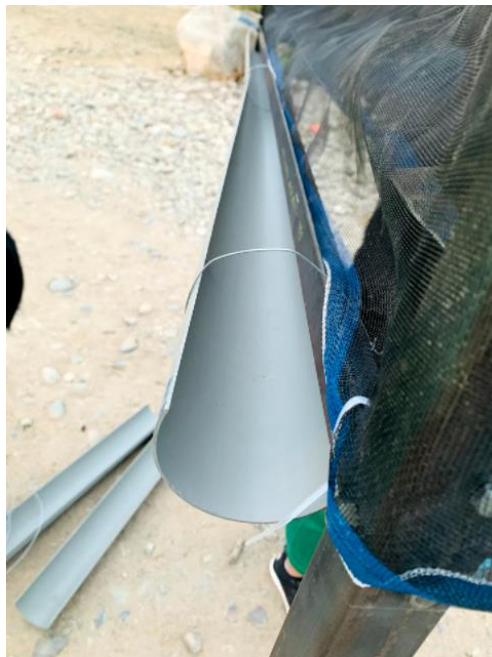
Figura 57. Perspectiva del drenaje y salida de tubería para la respectiva caída del agua en el almacenamiento.
