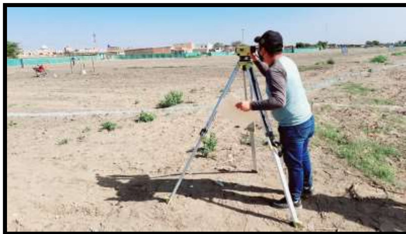
TOMA 06: En esta toma se aprecia al segundo topógrafo efectuando el Levantamiento Altimétrico.
