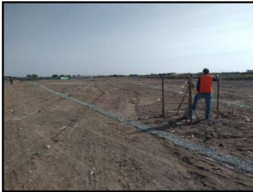
TOMA 04: En esta toma se aprecia desde otro ángulo los trabajos de topografía en la H.U. “Trébol House”.
