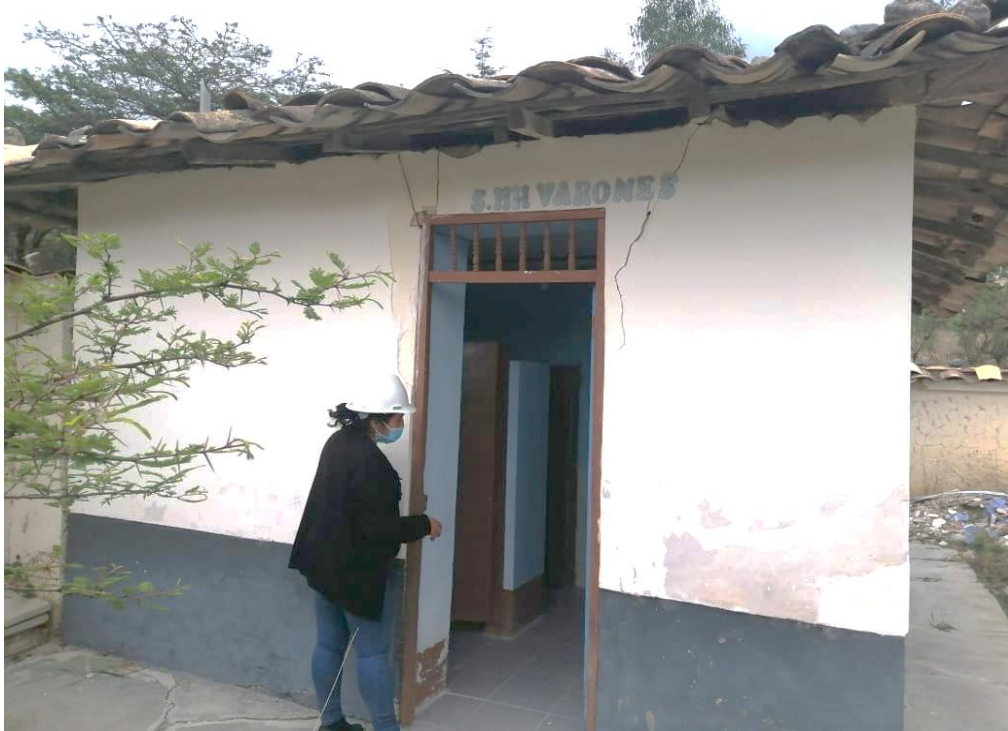
Fotografía 3: Inspección de los módulos de servicios higiénicos para varones de la institución educativa Mariavilca 82096.
