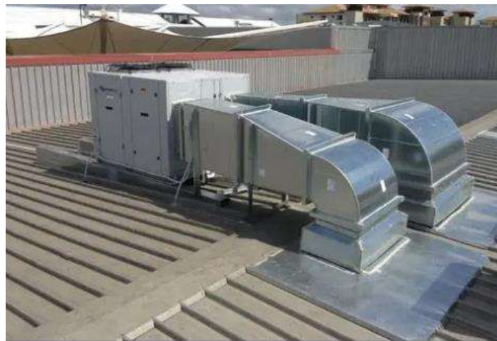
Figura 8. Equipos Roof top.
