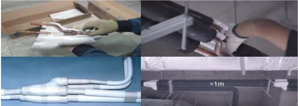
Figura 36. Finalización del proceso de acoplamiento y soldadura de los Banch o distribuidores.
