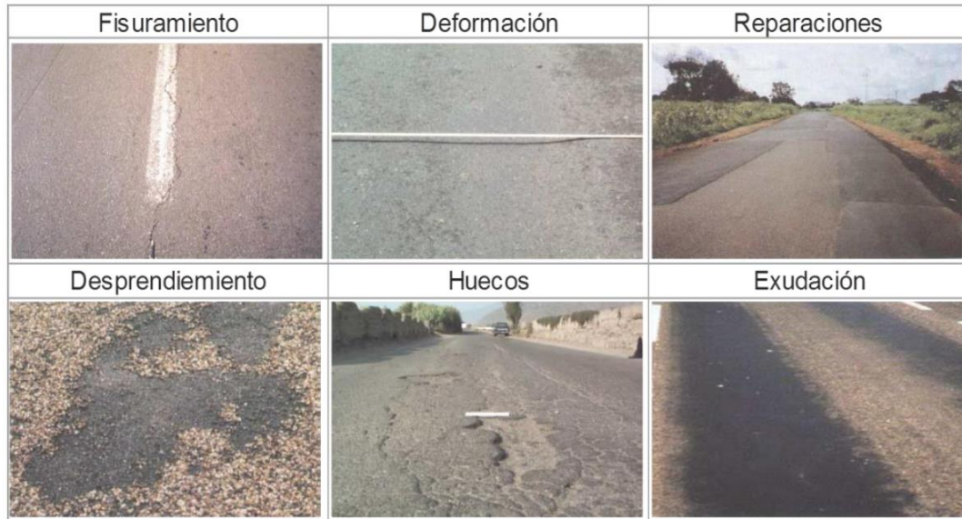
Figura 4: Daños en Pavimentos Básicos
