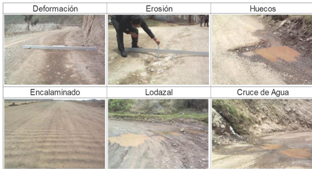
Figura 3: Daños en Carreteras No Pavimentadas
