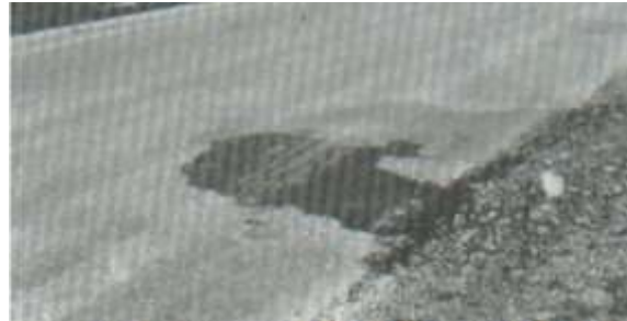
Falla Baches Severidad Media.
