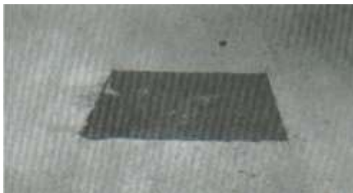
Falla Baches Severidad Baja
