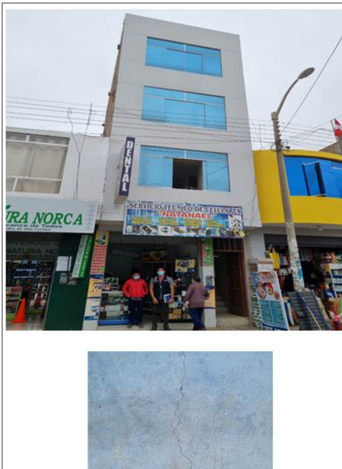
Figura 92. Edificación N°07 y patologías.
