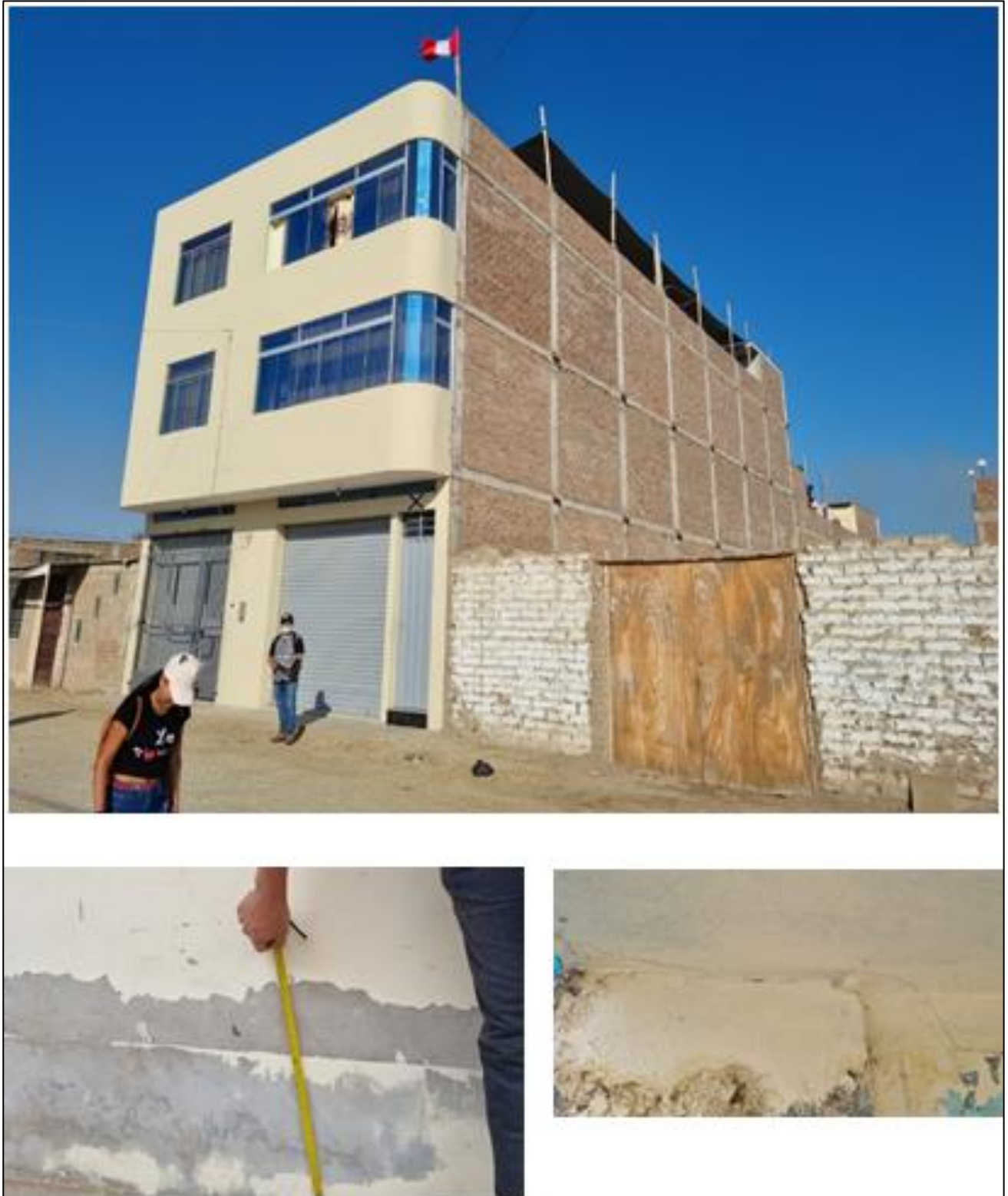
Figura 103. Edificación N°18 y patologías
