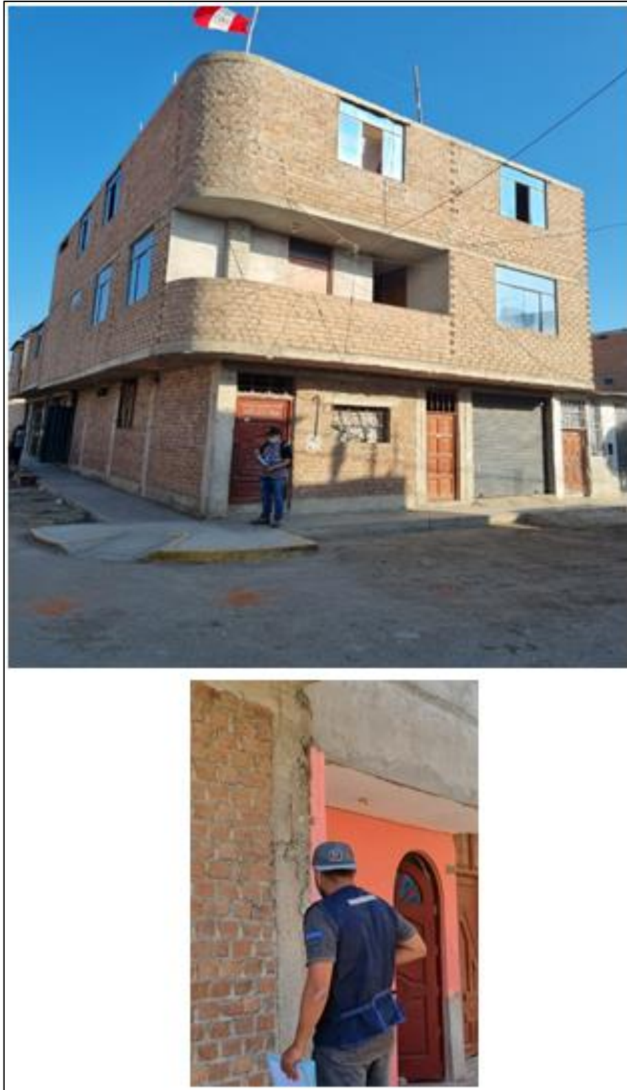
Figura 104. Edificación N°19 y patologías
