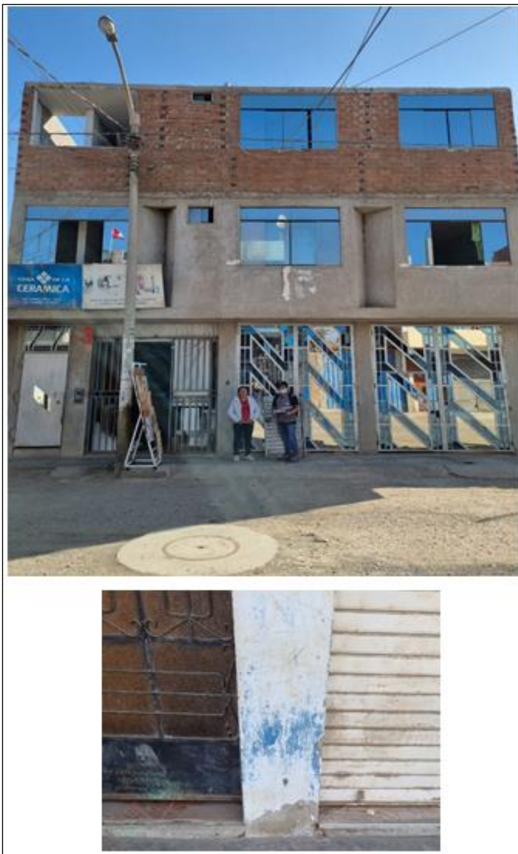
Figura 98. Edificación N°13 y patologías
