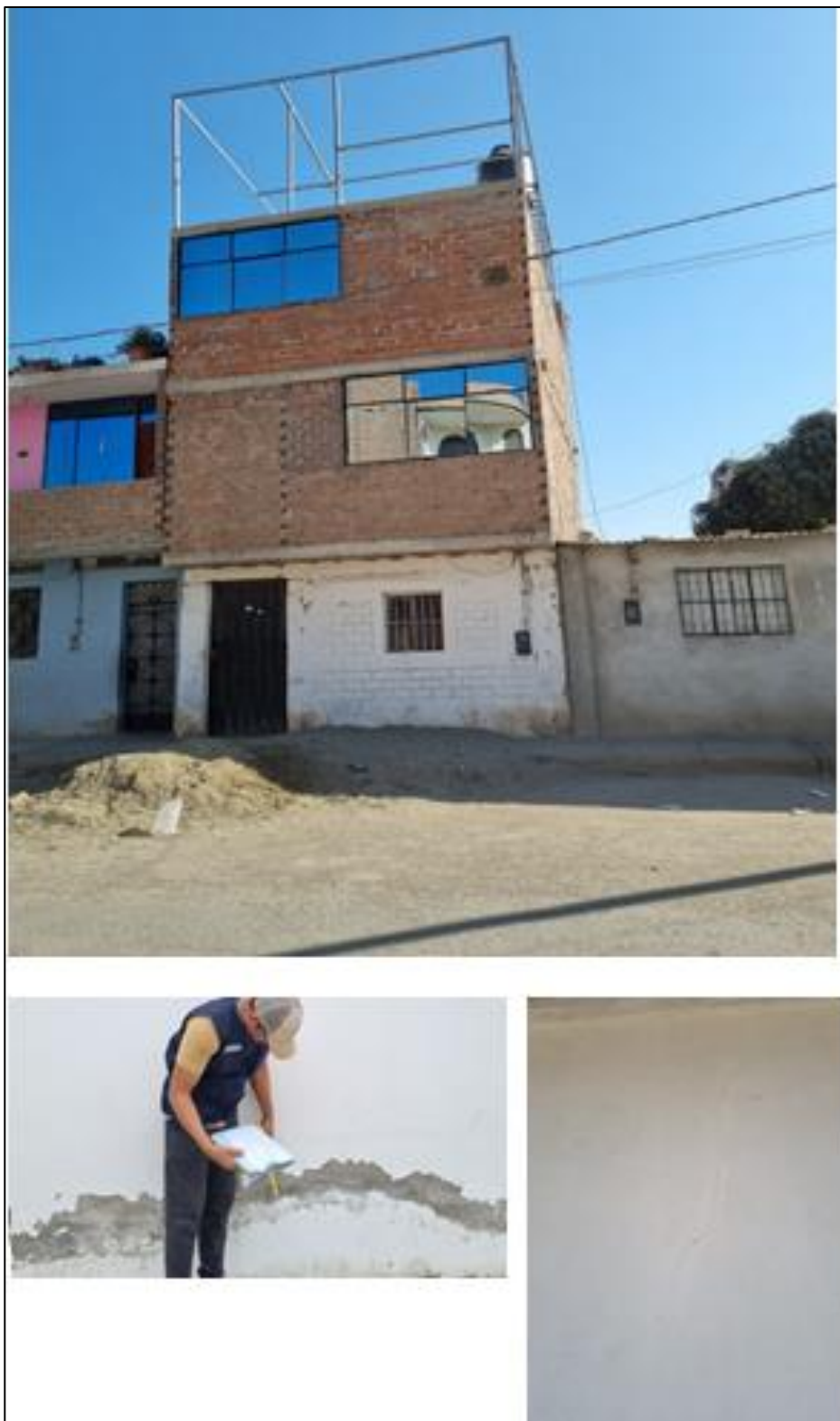
Figura 100. Edificación N°15 y patologías
