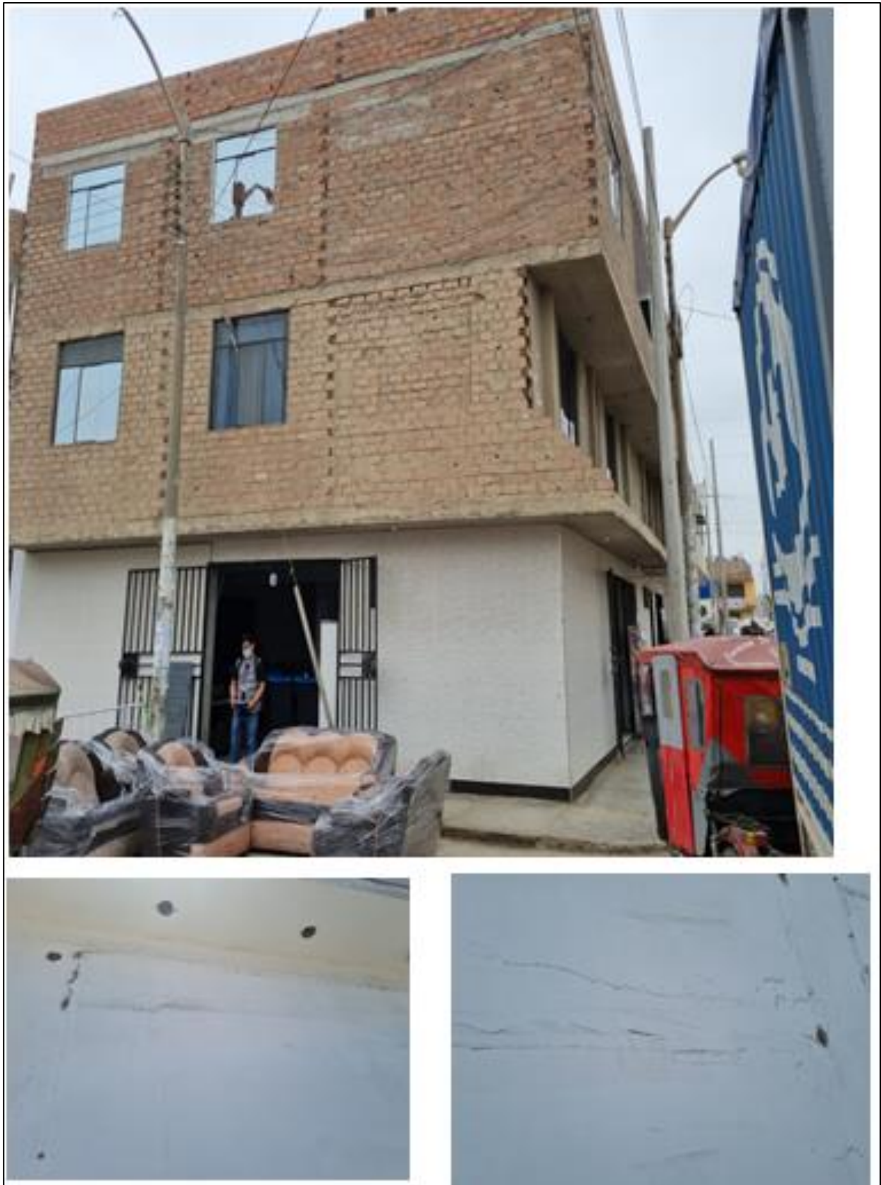
Figura 91. Edificación N°06 y patologías.
