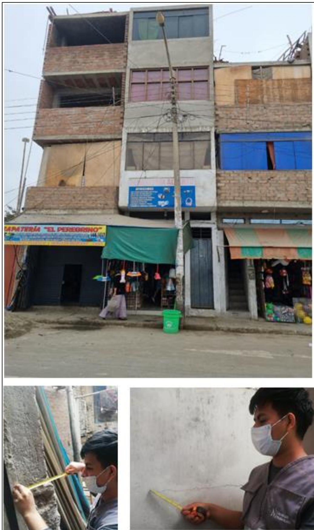
Figura 89. Edificación N°04 y patologías.
