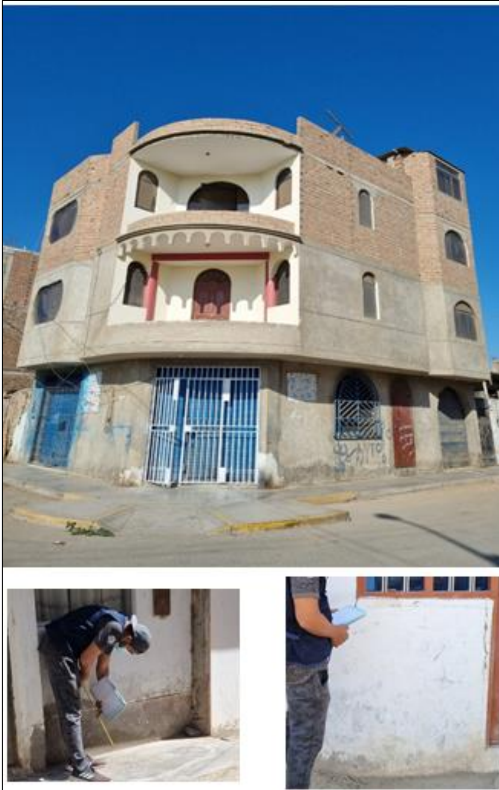
Figura 101. Edificación N°16 y patologías
