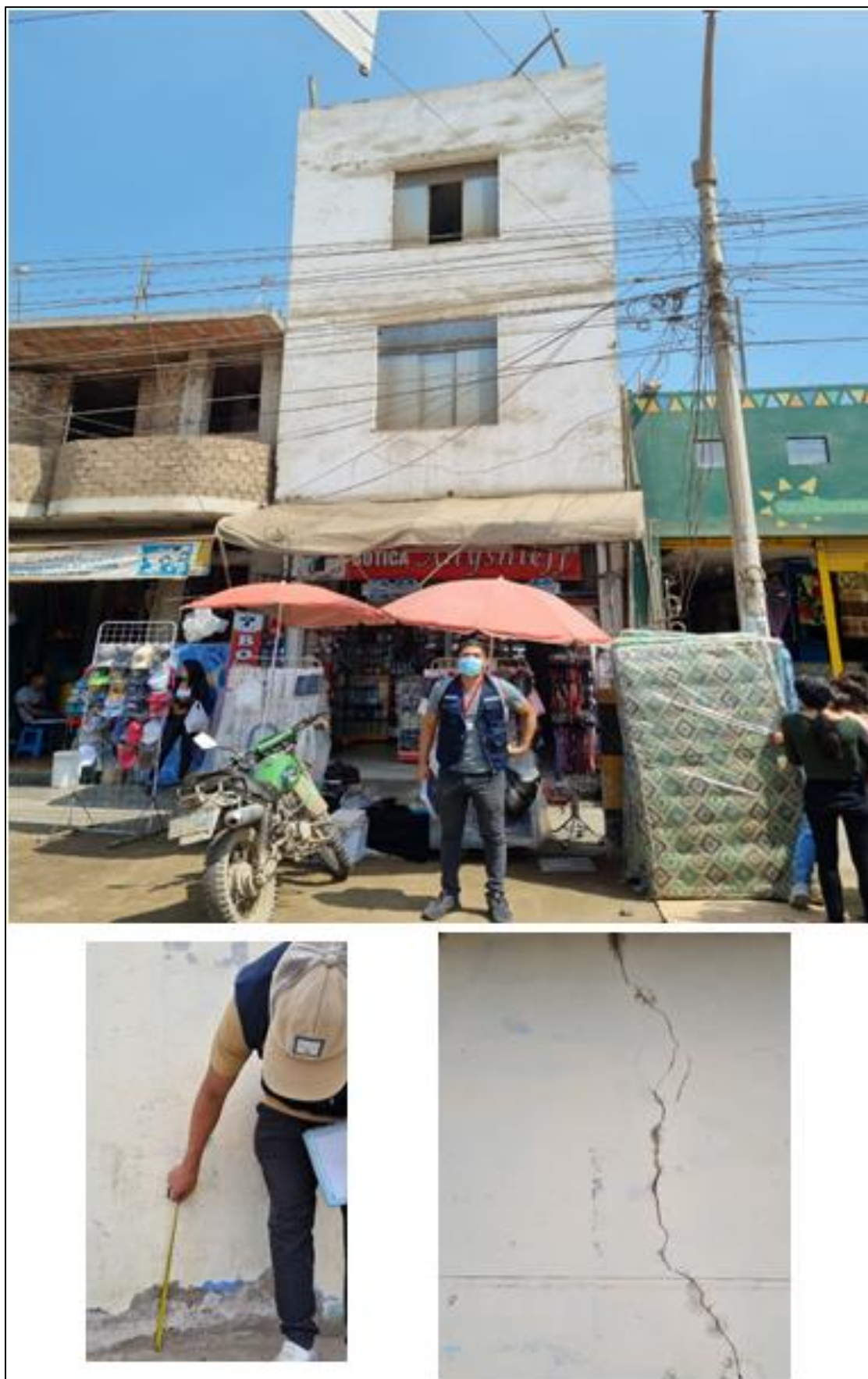
Figura 97. Edificación N°12 y patologías
