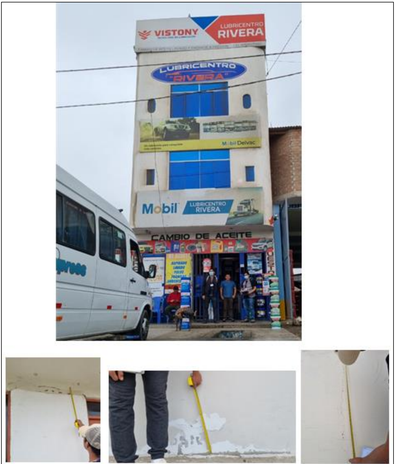
Figura 86. Edificación N°01 y patologías0
