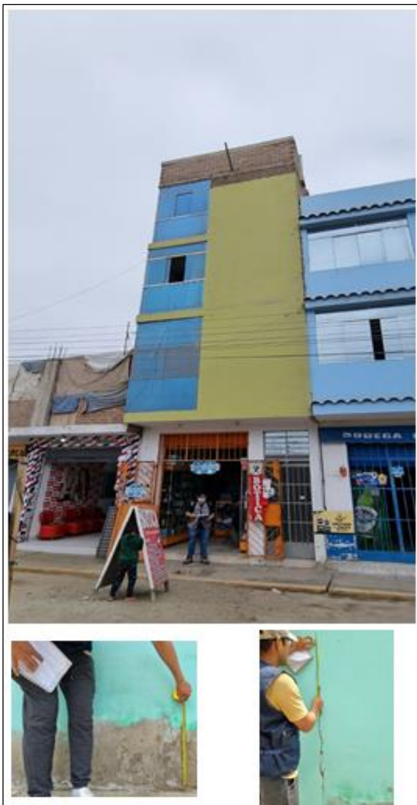
Figura 95. Edificación N°10 y patologías
