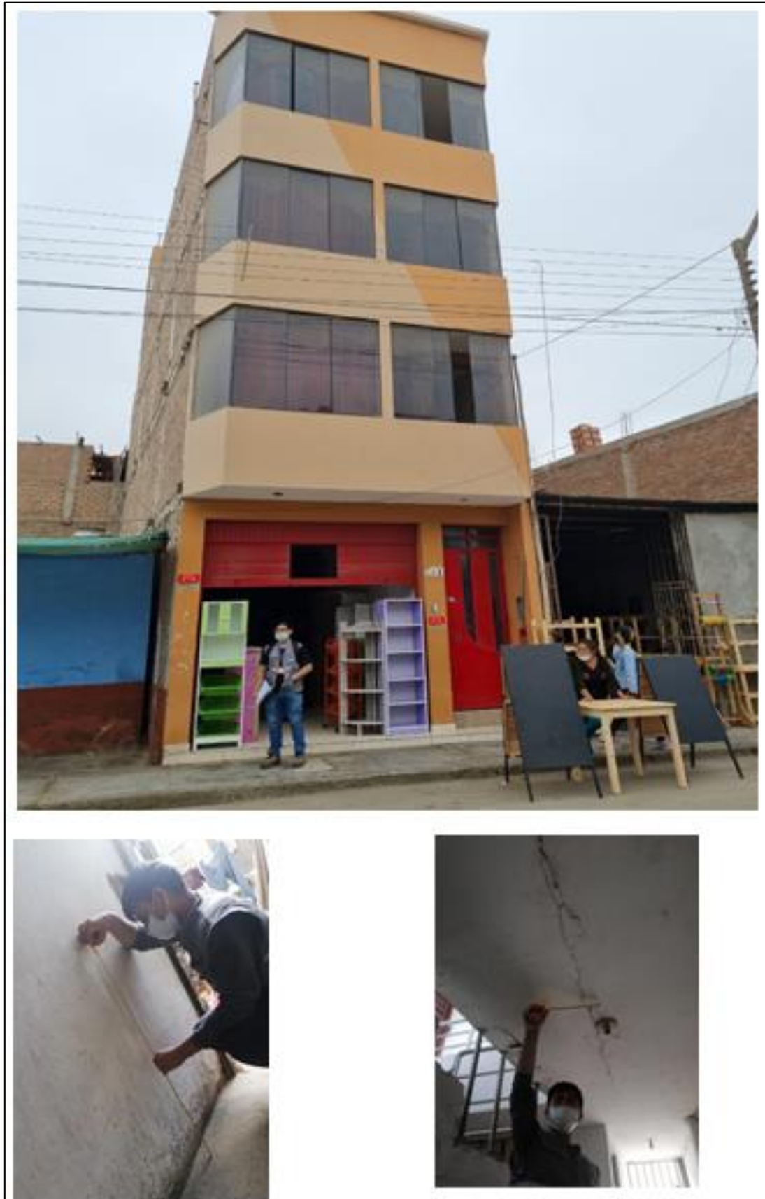
Figura 90. Edificación N°05 y patologías.
