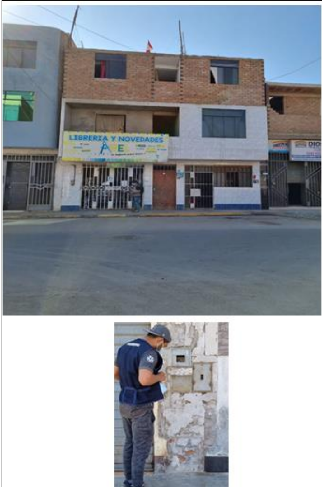
Figura 99. Edificación N°14 y patologías
