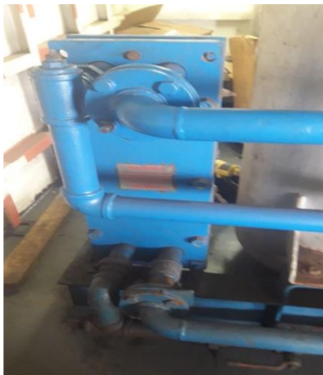
Figura 24 Tanque Separador de Aceite
