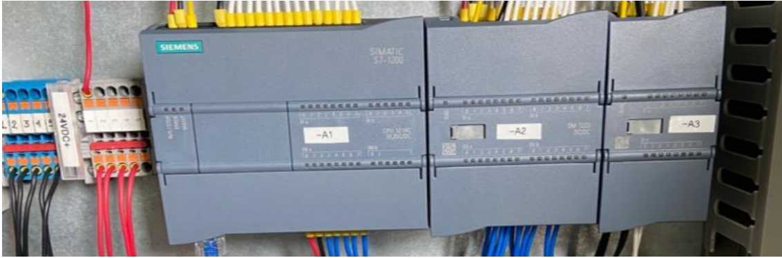
Figura 38 PLC SIEMENS S7-1200
