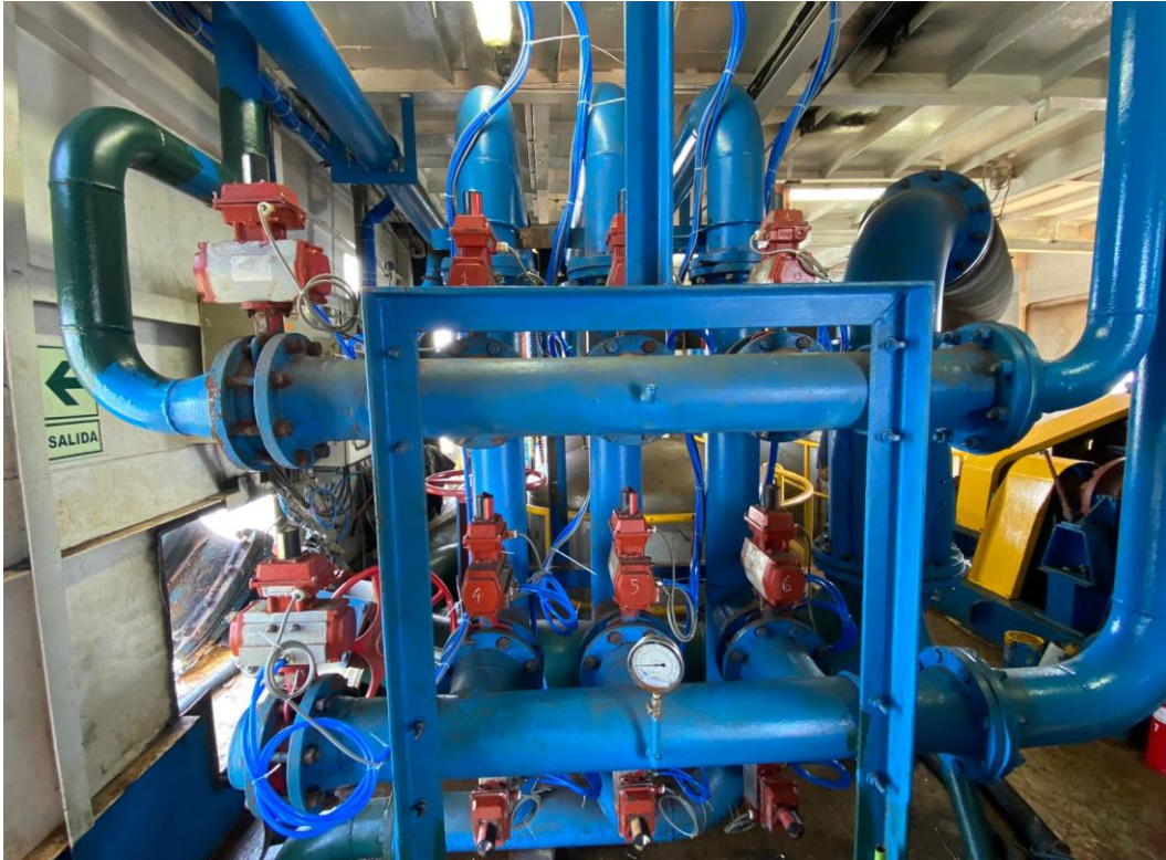
Figura 50 Mantenimiento a los actuadores de las válvulas Bray, cambio de Orines, desgaste de funcionamiento
