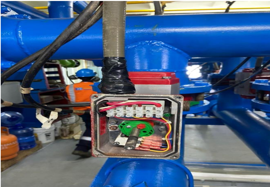
Figura 47 Mantenimiento del posicionador y calibración del switch de las válvulas Bray Fuente: elaboración propia
