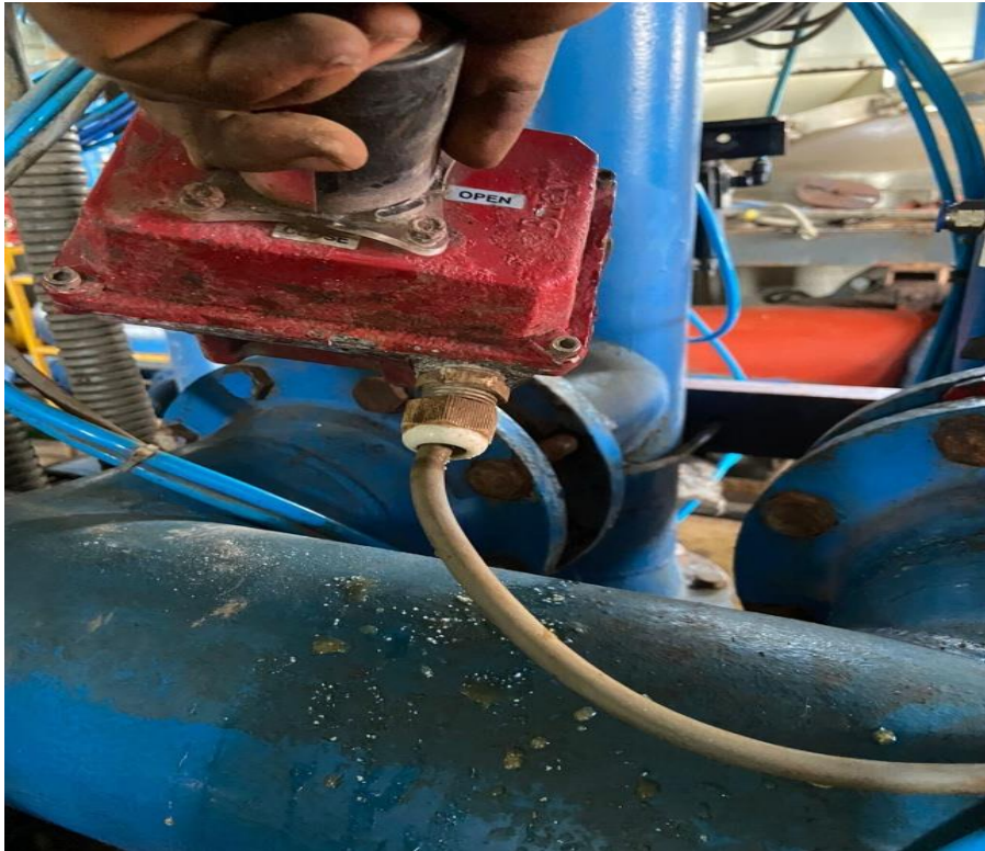
Figura 48 Cambio de cableado de los visores Bray para rectificación de señales analógicas
