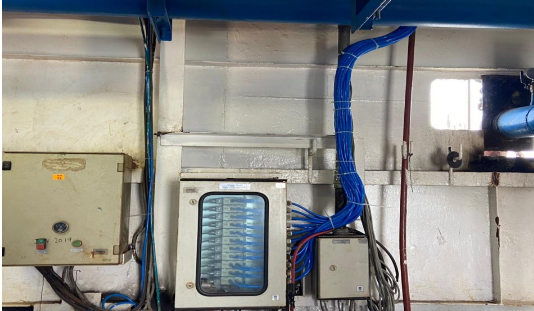
Figura 46 Mantenimiento del rack de electroválvulas y cambio de mangueras neumáticas Fuente: elaboración propia
