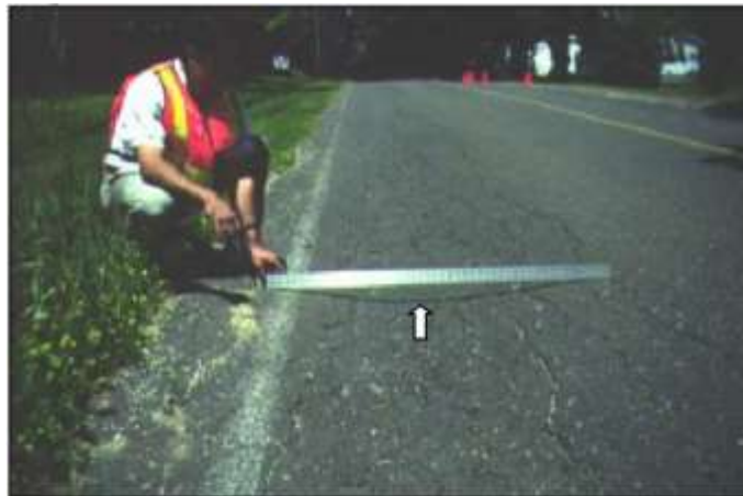
Figura 14. Pavimento con Depresión
