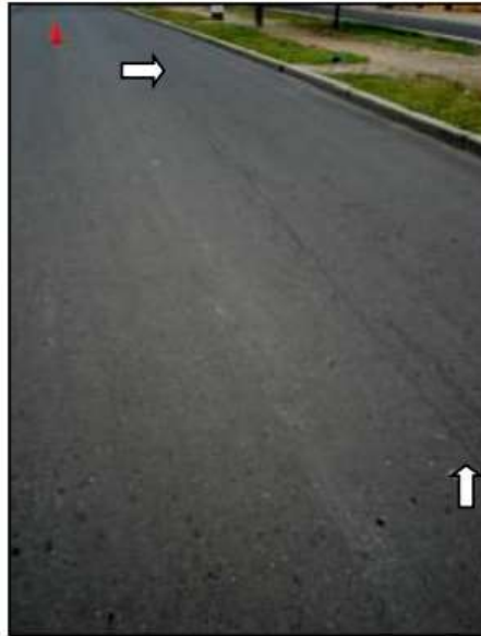
Figura 23. Pavimento con presencia de ahuellamiento
