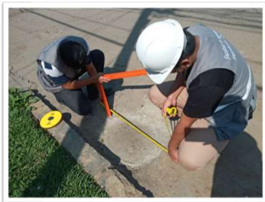
Figura 73. Tomando medidas de la falla parches.
