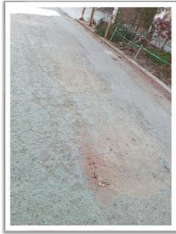
Figura 84. Falla de Piel de cocodrilo
