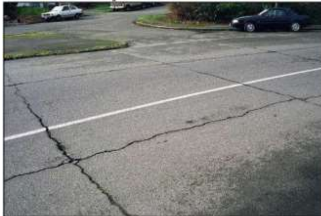
Figura 16. Grietas de reflexión de junta
