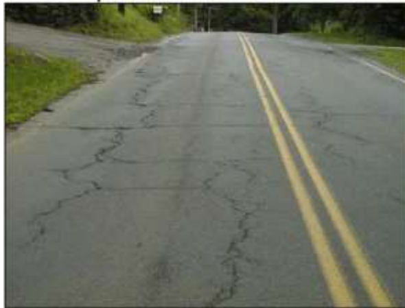
Figura 11. Grietas en bloque
