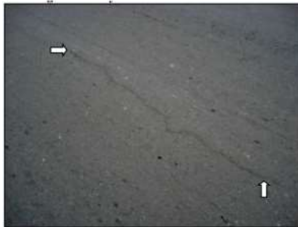
Figura 18. Grietas longitudinales y transversales
