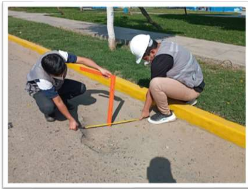
Figura 76. Midiendo la profundidad de la falla huecos.
