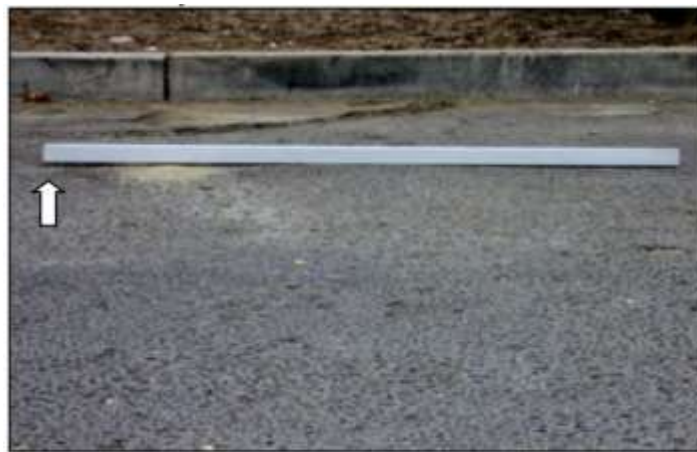
Figura 12. Abultamiento y hundimientos
