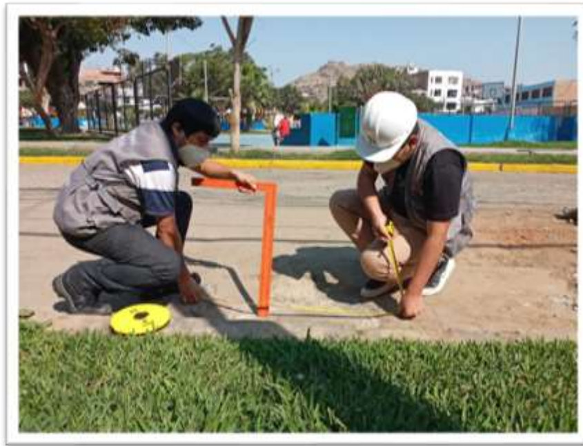
Figura 74. Midiendo la profundidad de la falla huecos.
