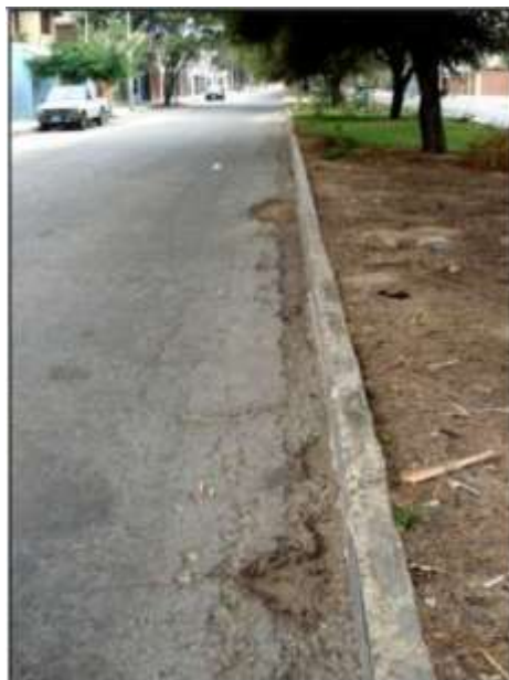
Figura 15. Grietas de borde
