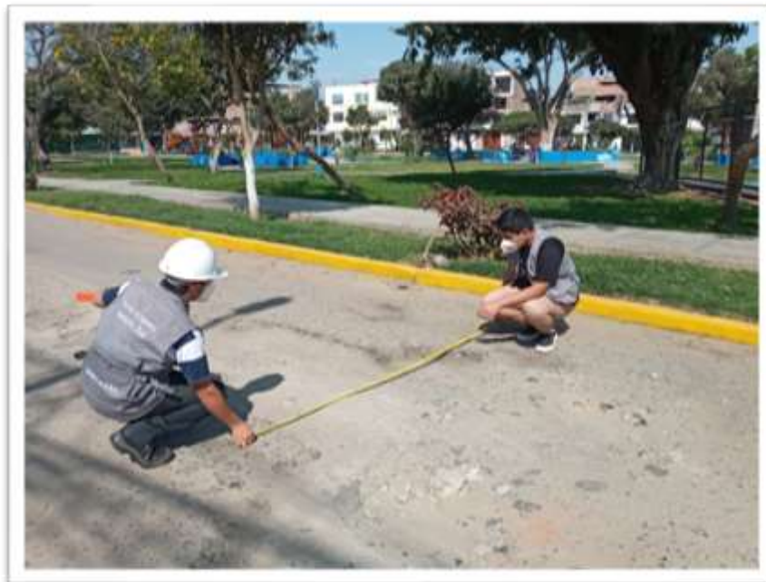
Figura 75. Tomando medida de la falla desprendimiento de agregados.
