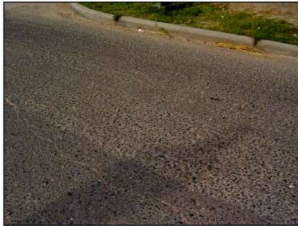
Figura 27. Meteorización o desprendimiento de agregados
