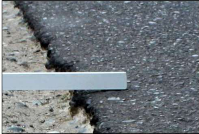
Figura 17. Desnivel carril / berma
