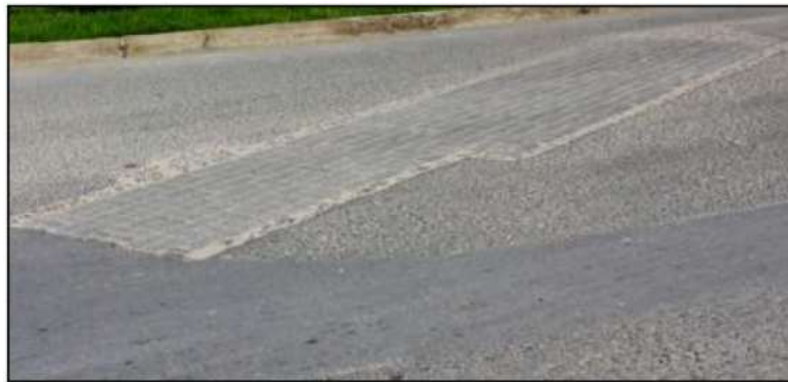
Figura 19. Pavimento con presencia parche
