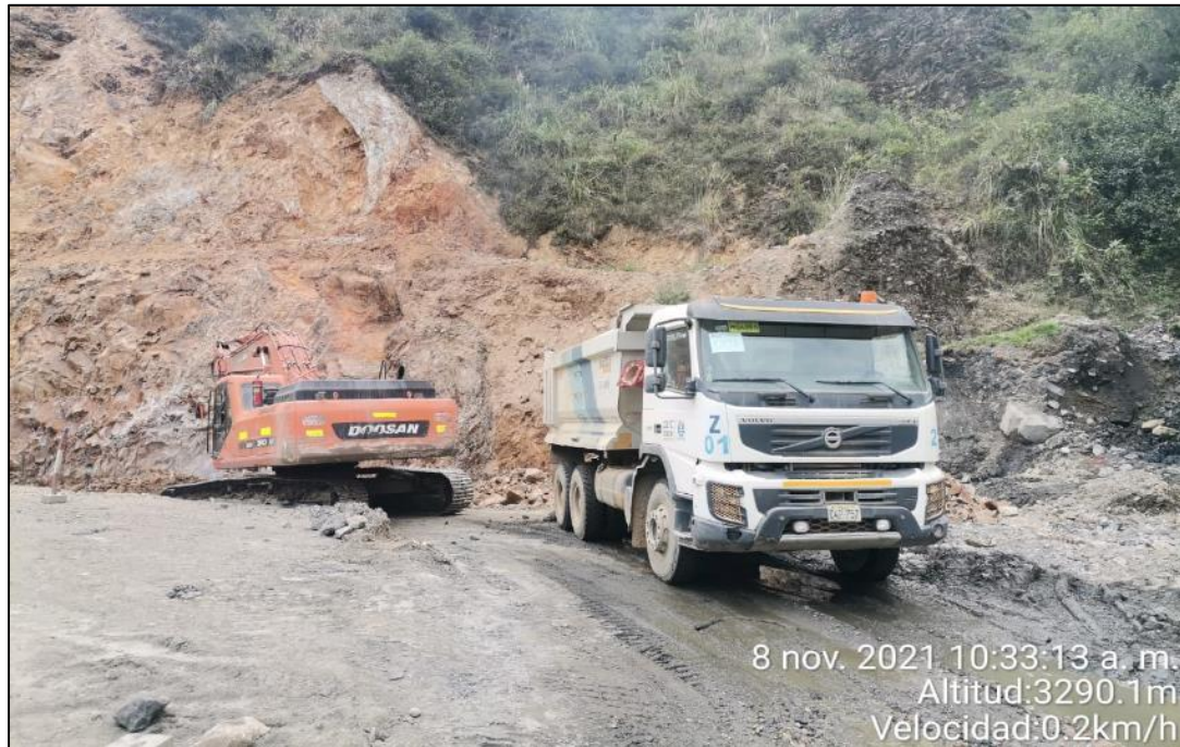
Figura 4. Zonas no Liberadas – Interferencias para la Ejecución del Proyecto
