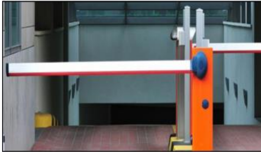
Figura 40: Control de acceso vehicular modelo ubicado dentro y al término de la rampa al nivel del sótano 01 y sótano 02 del Museo Nacional de Arqueología, Antropología e Historia del Perú para el Distrito de Pueblo Libre. Fuente: Modelo de sistema de acceso vehicular.
