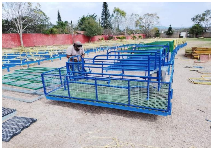
F6. Instalacion de equipos de maternidad
