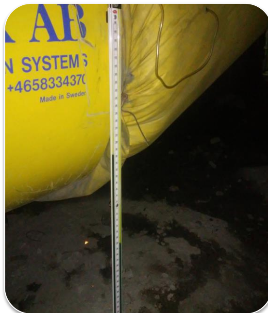
Se observa monitoreo de presión estática en ventilador
