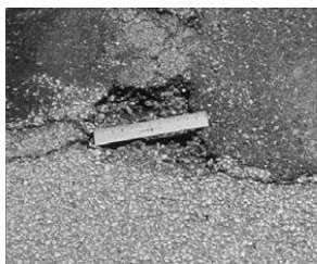
Fig. C.13- a : severidad baja
