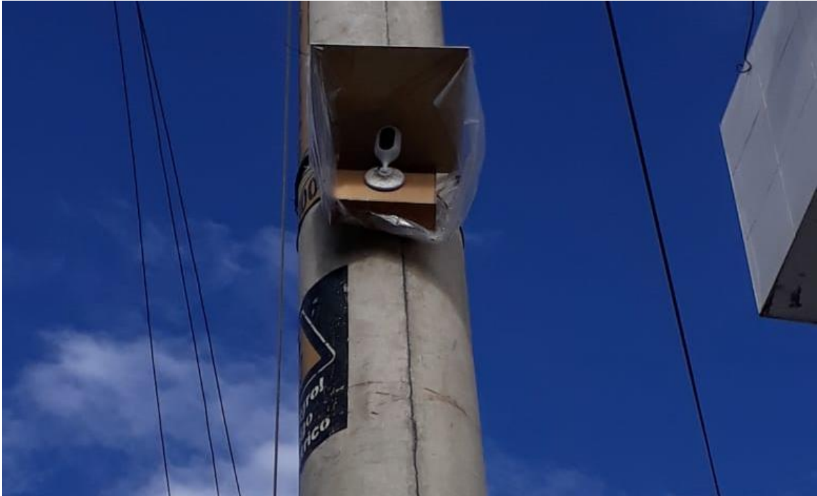
Fotografía N° 07: Intersección N° 01, enfoque de ubicación e instalación de Cámara N° 01
