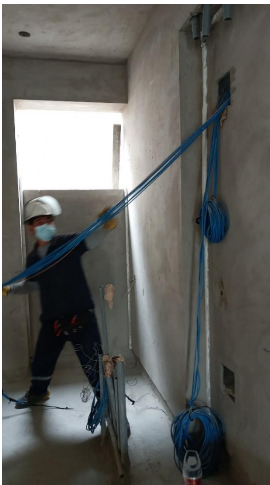
Fuente: Cableado estructurado Data Center - Sede Monterrico
