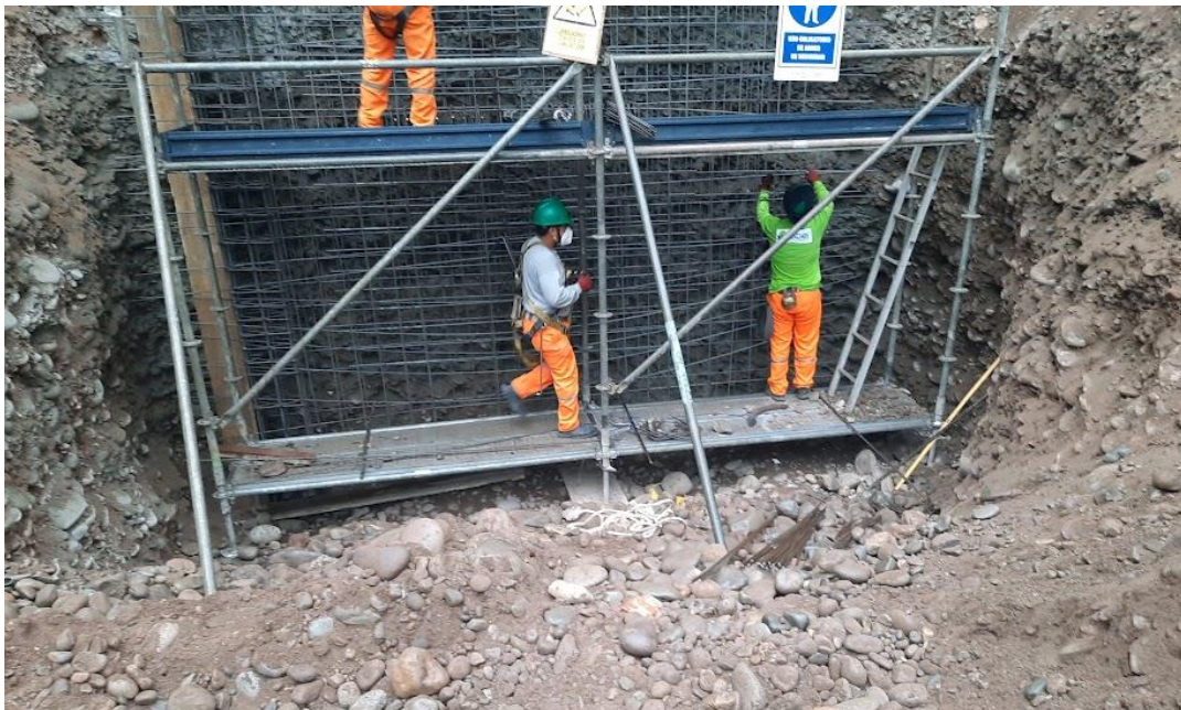
Figura 3. Falta tarjeta de liberación de andamio
