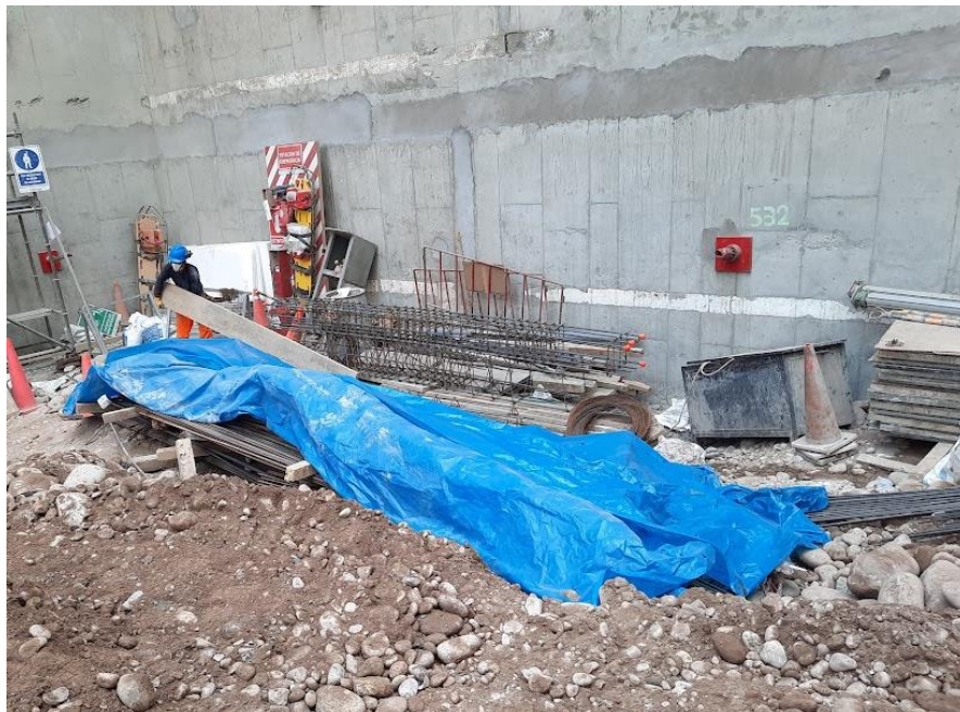
Figura 15. Acopio sin señalizar
