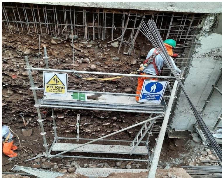
Figura 13. Andamio mal armado
