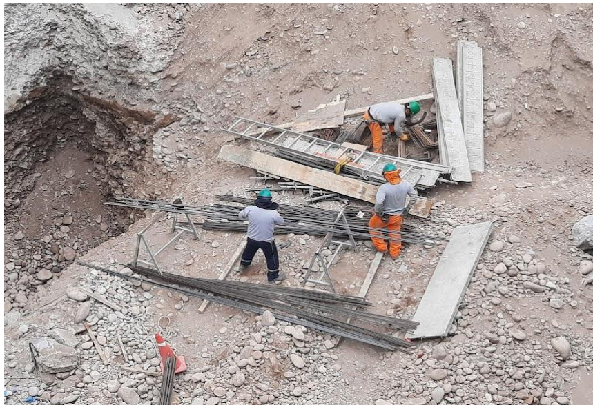
Figura 17. Área de trabajo sin señalizar
