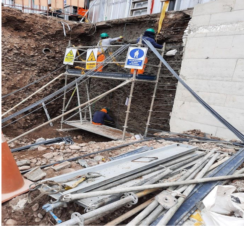
Figura 8. Material y área de trabajo desordenada
