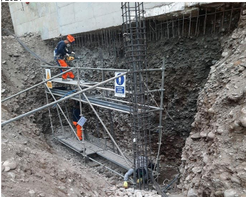
Figura 6. Andamio mal armado, trabajo de 2 actividades en simultaneo
