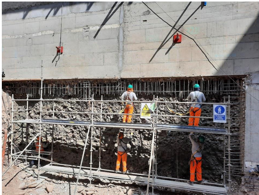
Figura 11. Andamio mal armado
