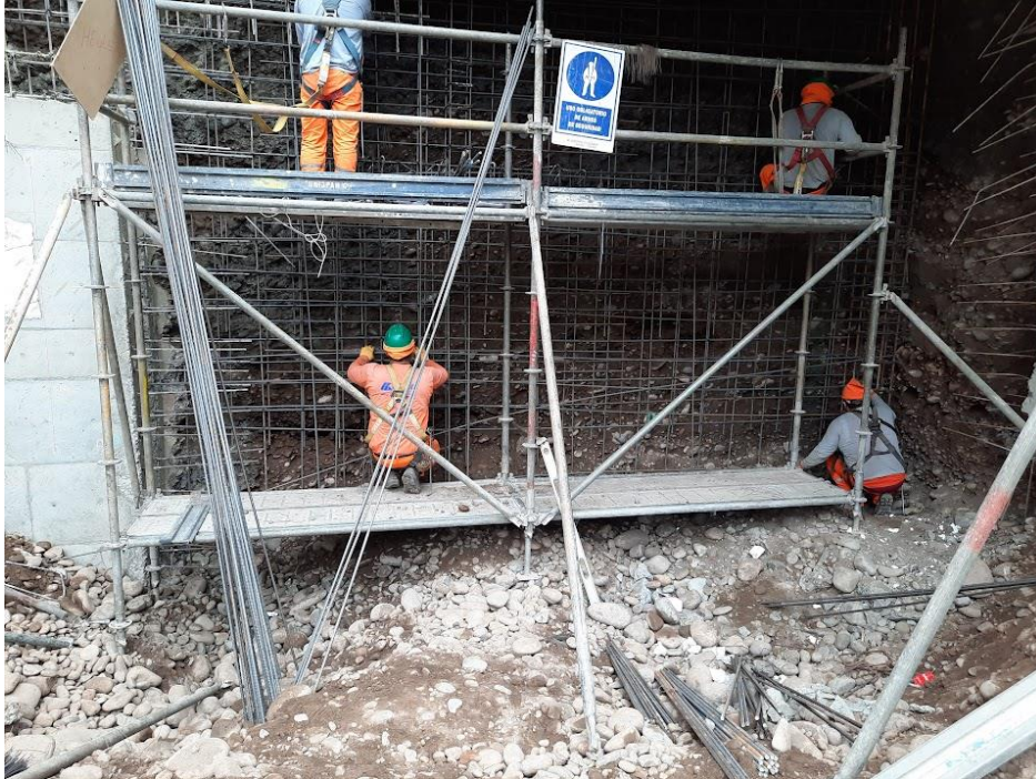
Figura 10. Andamio sin tarjeta de liberación, material desordenado
