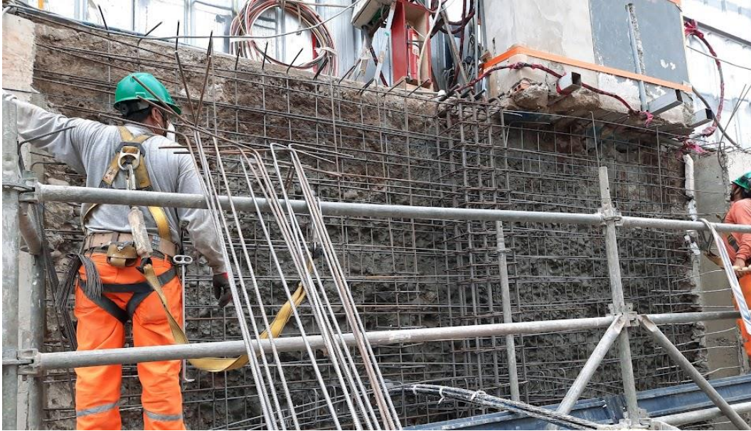
Figura 4. Personal propenso a sufrir cortes por material expuesto
