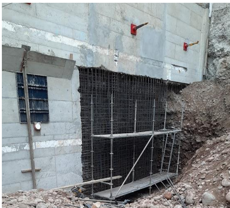
Figura 7. Desarmado de andamio sin tarjeta de inoperatividad
