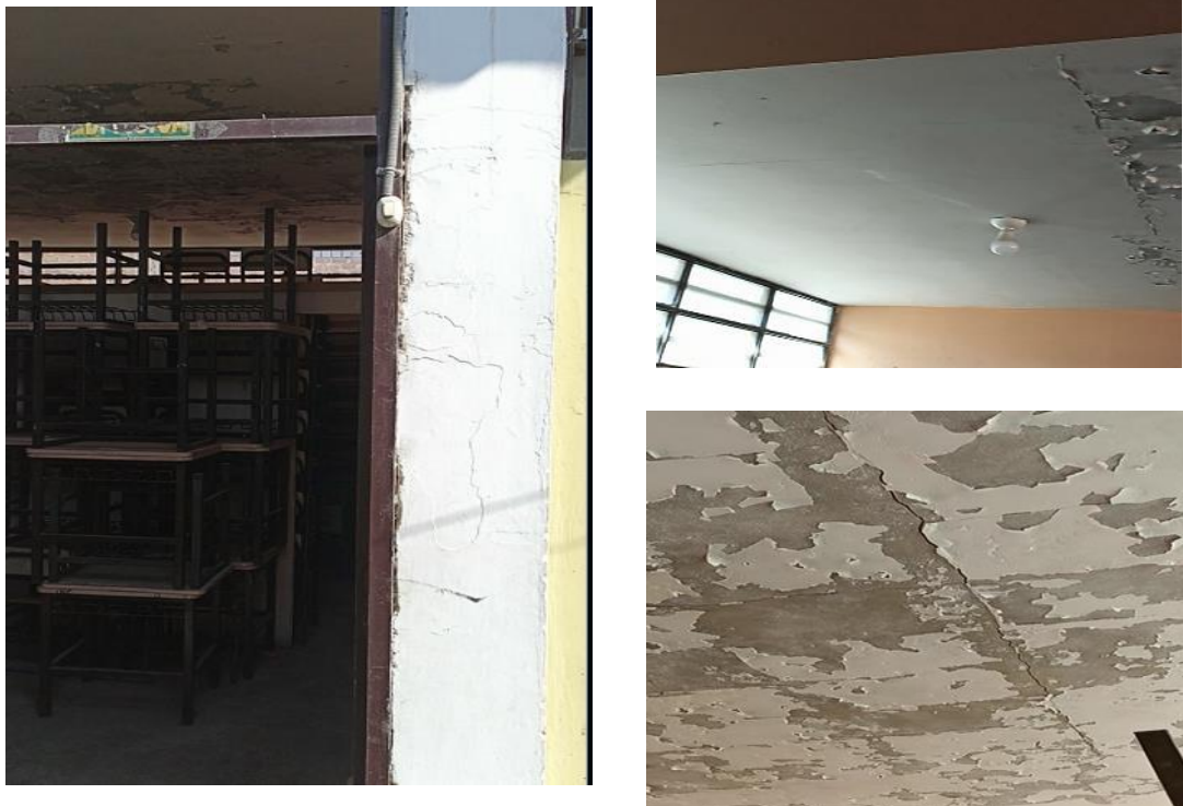
Figura 8. Tipo de fisuramiento. Nota. Fuente: Elaboración el autor
