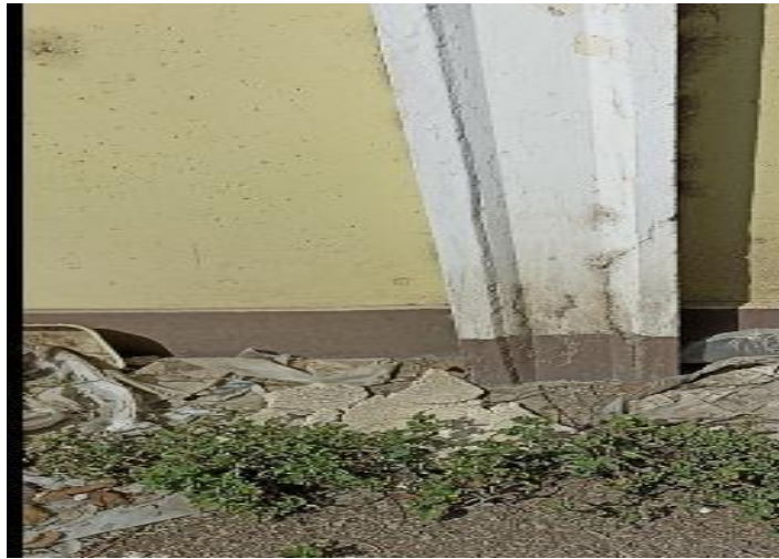
Figura 20. Fisuras por inadecuada conservación y protección ante la humedad y el ambiente.
