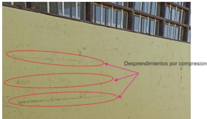
Figura 10. Desprendimientos por compresión.
