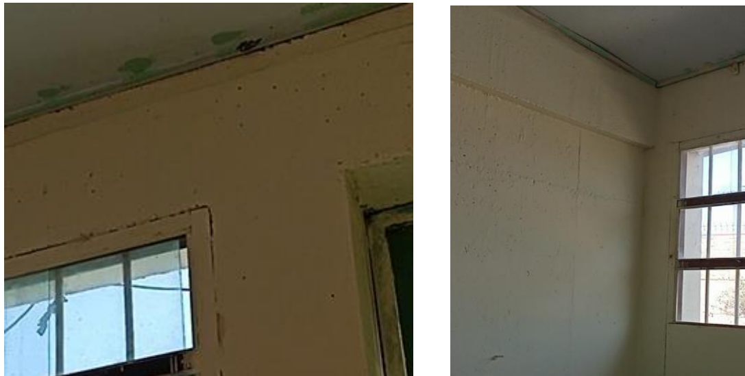
Figura 6. Aula 03 Disgregaciones desgaste de tiempo.
