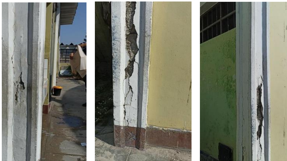
Figura 24. Erosión del concreto en columnas de servicios higiénicos.
