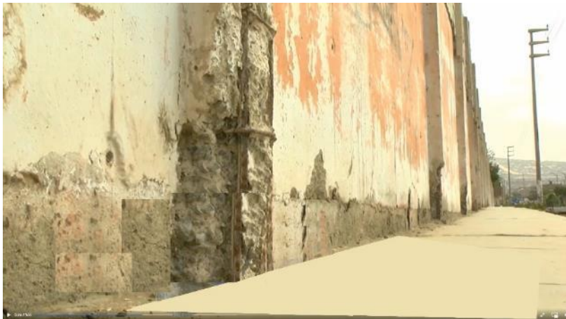
Figura 22 Falta de mantenimiento en los muros perimetrales.
