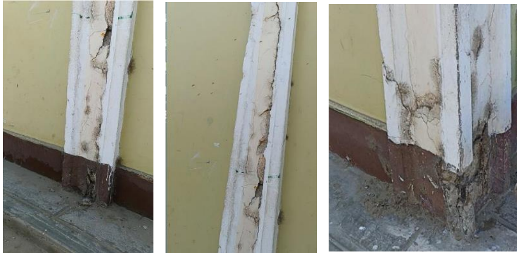
Figura 23. Uso inadecuado de las columnas del tanque elevado.
