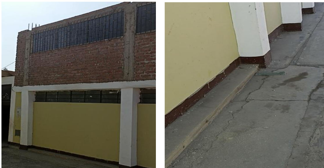
Figura 14. Fisura de vereda y viga de amarre por desplazamiento de zócalo y columna.
