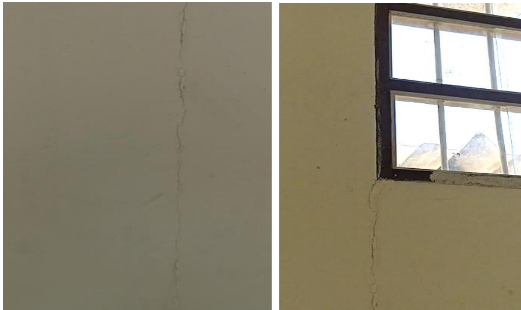
Figura 11. Aula 06 y fisura por desplazamiento por sobre peso de segundo piso.
