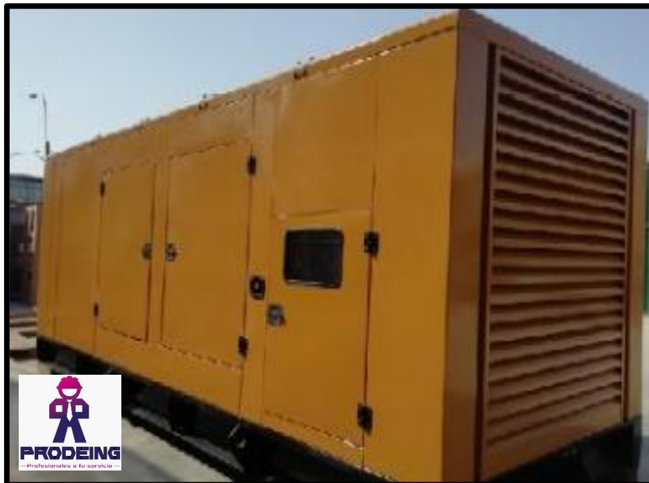
Figura 3. Grupo electrógeno encapsulado.
