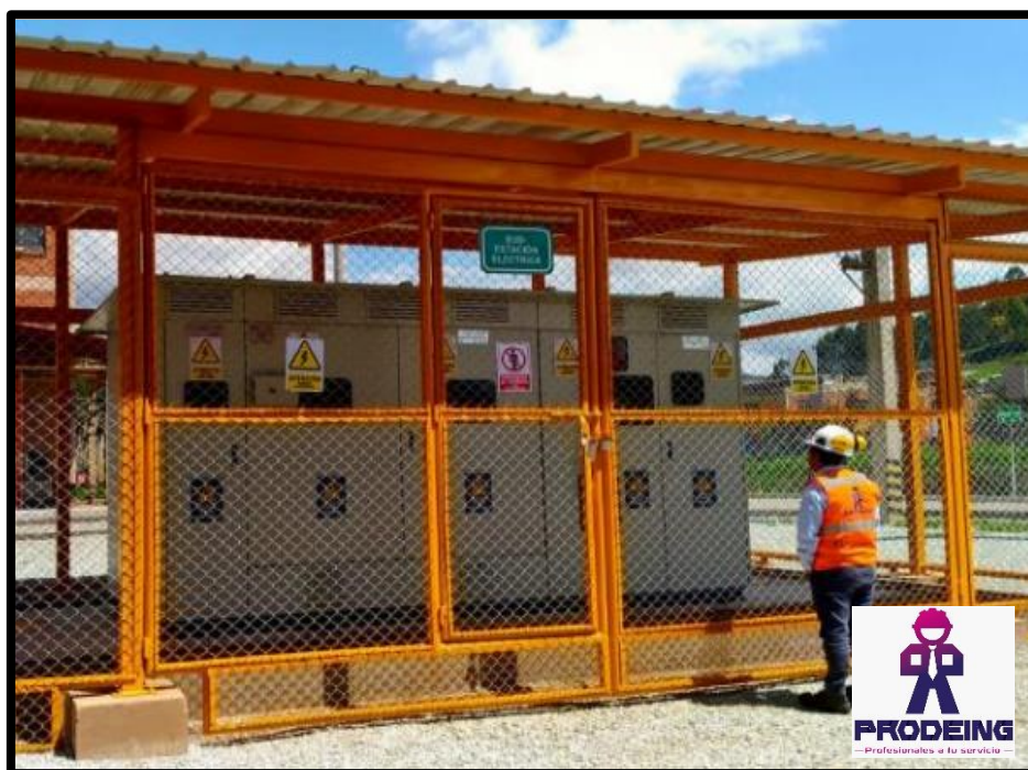
Figura 4. Celdas de media tensión instalada minera Cachimayo.
