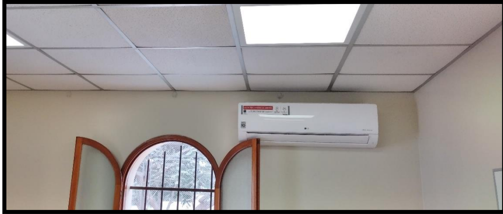
Figura 14. Instalación de Aire Acondicionado
