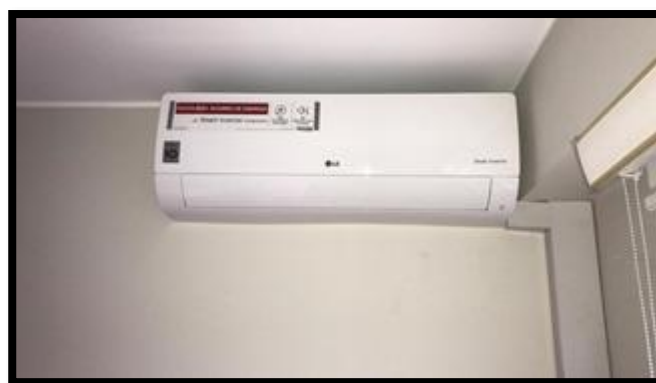
Figura 39, sistema de aire acondicionado tipo Split en pared
