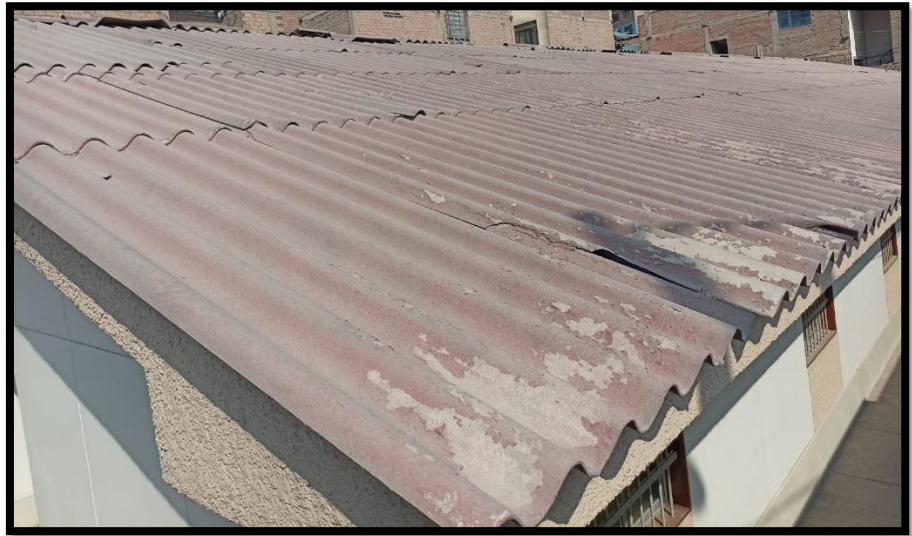
Figura 33, Eternit en mal estado, cumplió su vida útil
