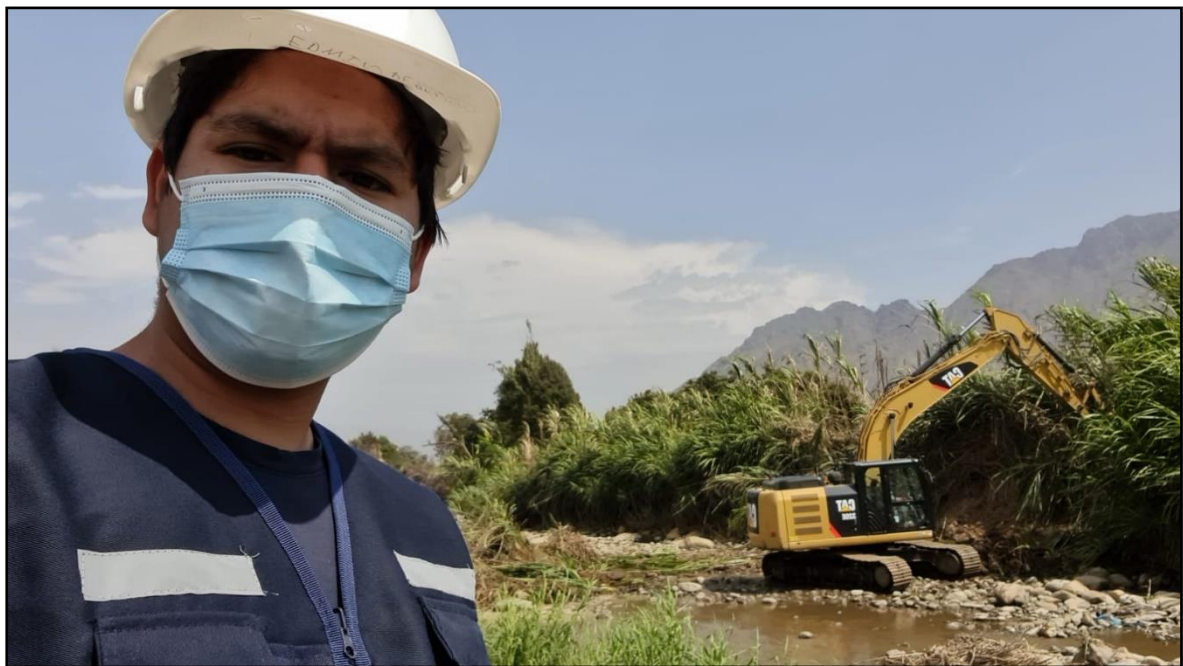
Figura 68: Edwin Pérez en Obra – Actividad de Desvío de Río y Limpieza de Terreno.
