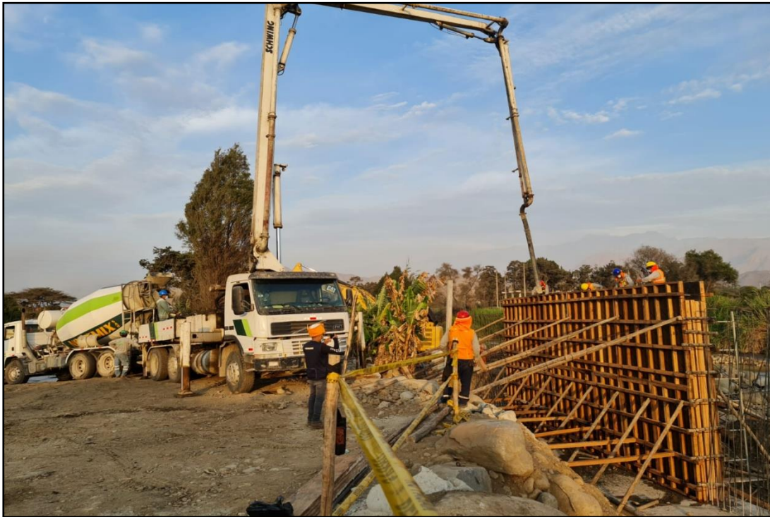
Figura 71: Vaciado de Concreto premezclado F'c=210 \text{ kg/cm}^2 en Pantalla de Muro de Contención Margen Izquierdo
