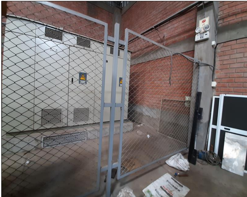
Figura 14. Ausencia de señalizaciones de peligro en la estación eléctrica Fuente: PolimiQ del Perú
