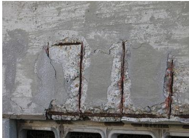
Figura 15: Daño químico en el concreto
