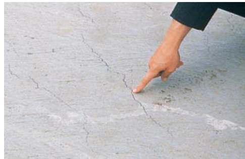
Figura 11: Fisuración por retracción plástica
