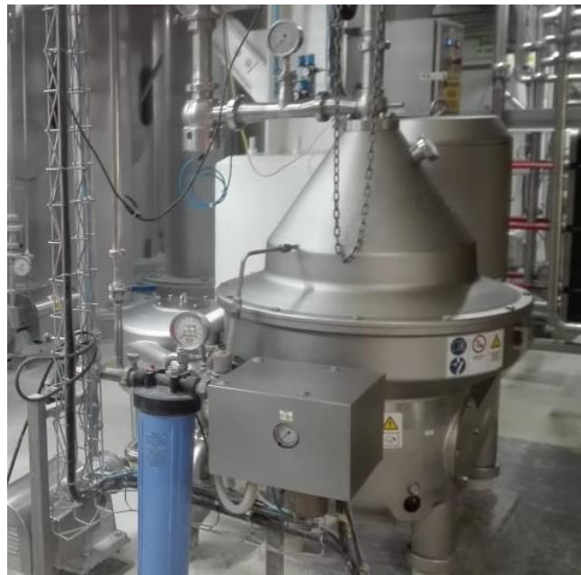
Figura 19. Clarificadora MSE 100 Fuente: Elaboración propia
