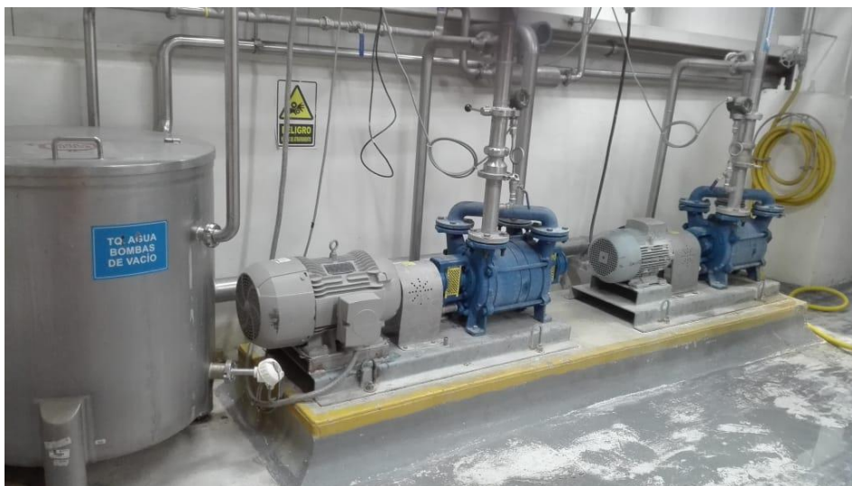
Figura 20. Bombas de vacío Fuente: Elaboración propia
