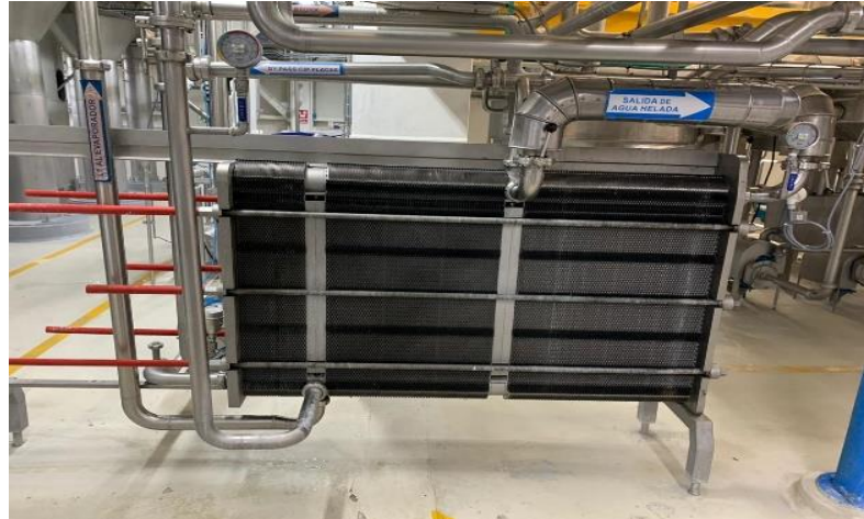
Figura 17. Intercambiador de calor Fuente: Elaboración propia
