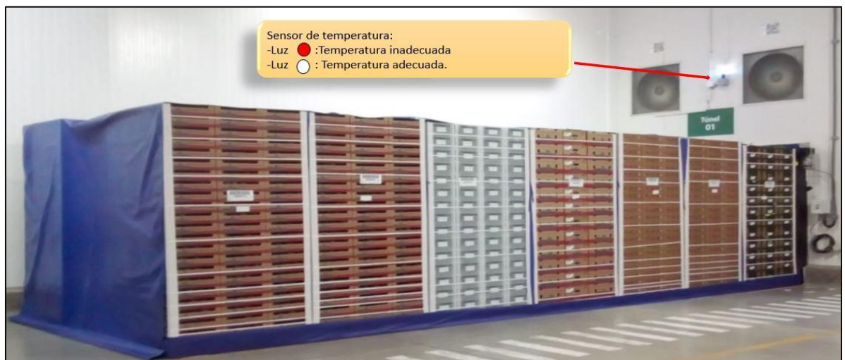
Figura 8. Sensor de control de temperatura
