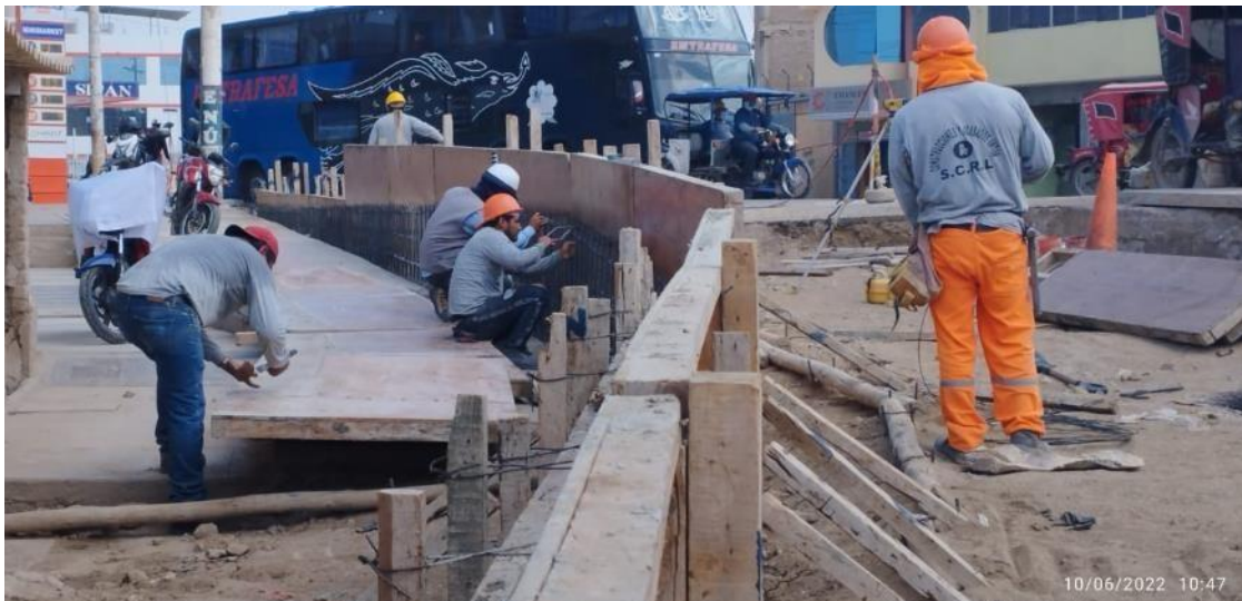
Figura N°22: Ejecución de Adicional de Obra N°02 (Construcción de Muro de Contención) aprobada.
