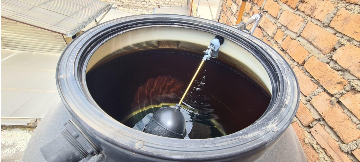
Figura N 56: Tanque elevado presente sedimentación y no cuenta con tubería de rebose, corresponde a la comisaría central.
