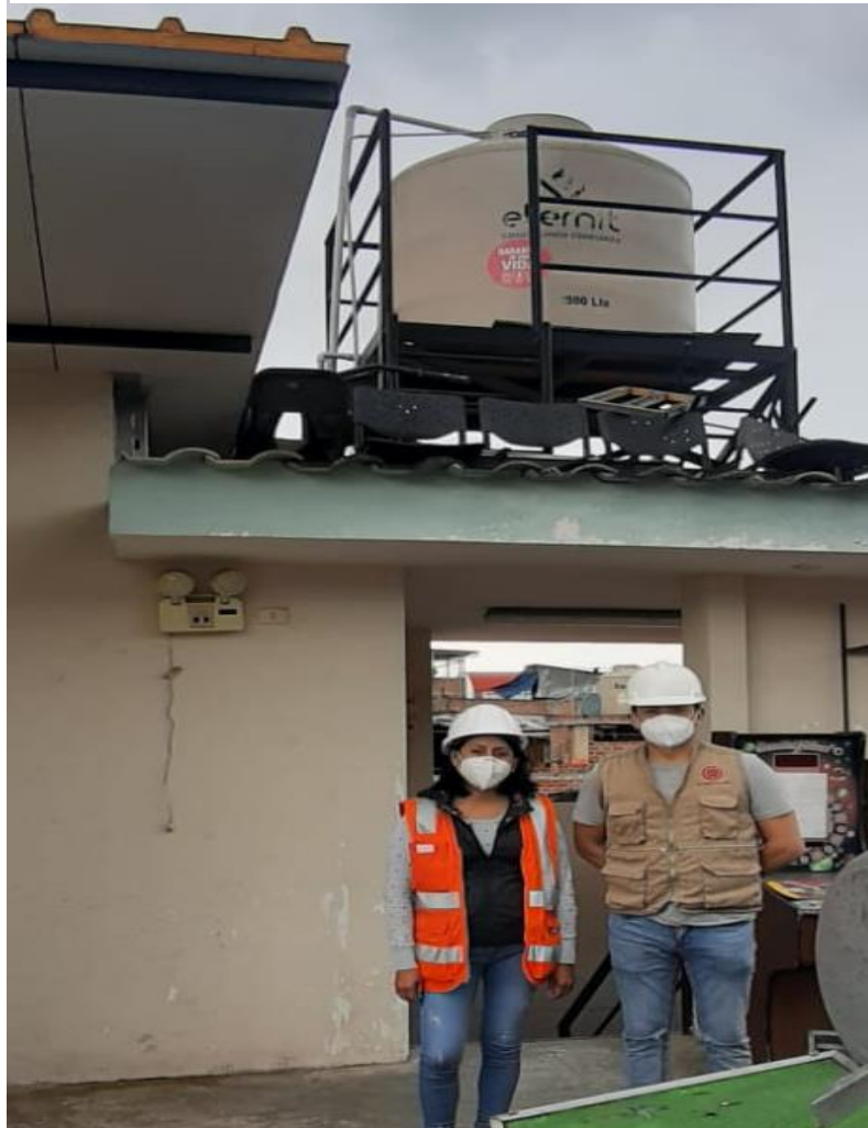
Figura N 60: Tanque elevado no cuenta con acceso para mantenimiento, corresponde a la comisaría de San José.
