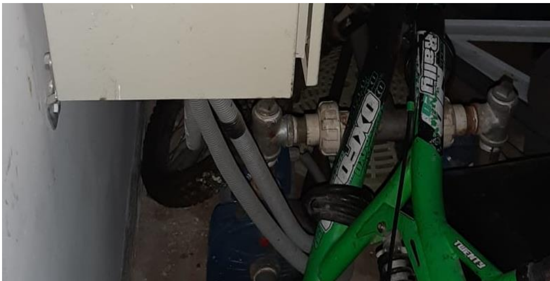
Figura N 59: Tubería se encuentra bajo bicicletas sin acceso para su mantenimiento, corresponde a la comisaría de San José.
