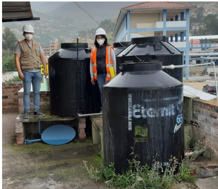
Figura N 65: Tanques elevados sin tapa hermética, corresponde a la unidad de USE.
