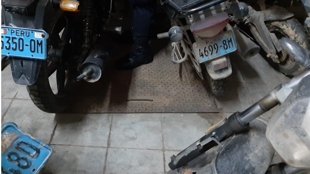
Figura N 58: Tanque cisterna está ubicado bajo almacén de motos, corresponde a comisaría de San José.
