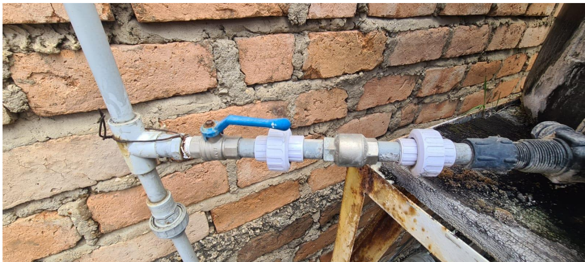
Figura N 57: Se empleó válvula check con uniones universales correspondiente a dependencia policial OFICRI.
