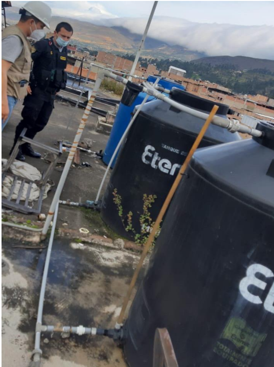
Figura N 51: Tres tanques elevados de los cuales dos no cuentan con tapa y uno de ellos no tiene tubo visor correspondientes a la unidad Escuadrón de emergencia.
