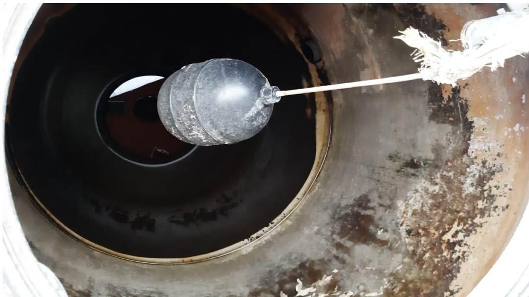
Figura N 54: Válvula de control se encuentra en mal estado y no controla el llenado del tanque, corresponde a la DIVINCRI.
