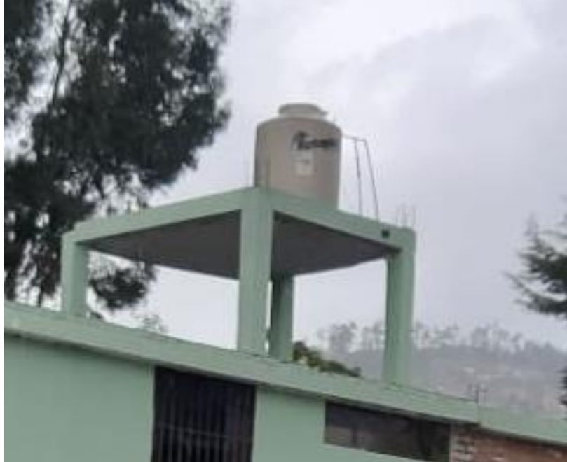
Figura N 64: Tanque elevado cuenta con su propia base uniforme y espacio para mantenimiento, corresponde a Inspectoría.
