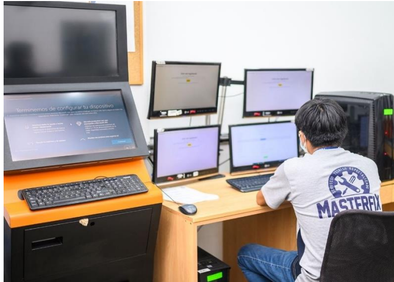
Figura 4. Instalaciones eléctricas, de red y sistemas de video
