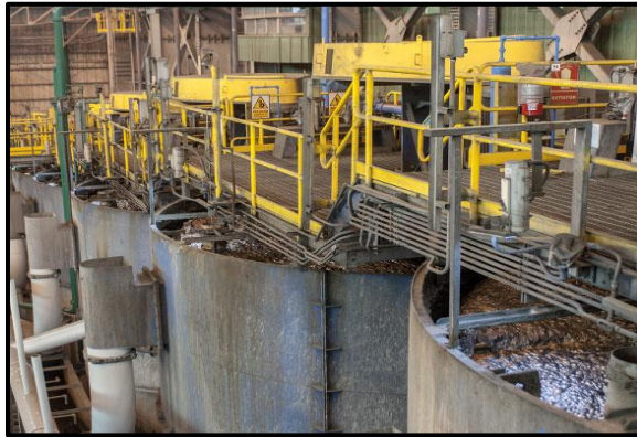
Figura 10. Flotación y Reactivos, Gravimetría y Remolienda Fuente: Gold Fields
