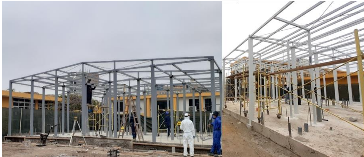
Figura N° 3-70: Instalación de columnas, viguetas, cerchas, correas, templadores metálicos. Foto de la derecha muestra las estructuras metálicas con pintura en los módulos.
