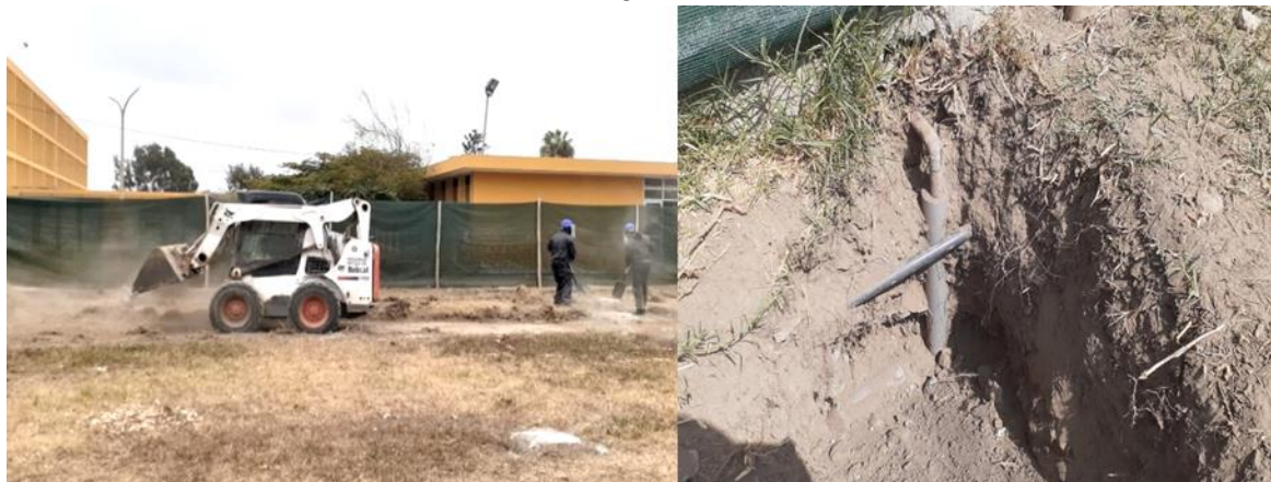
Figura N° 3-65: Excavación de terreno con Bobcat y ubicación de la red de oxígeno (tanque criogénico a la UPS Emergencia UCI)
