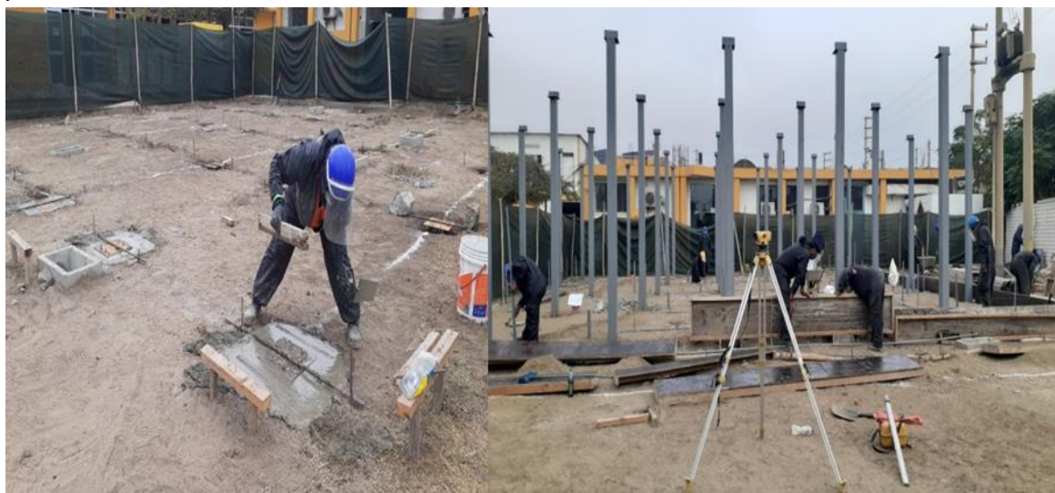
Figura N° 3-67: Vaciado de dados de concreto con concreto f'c=210 kg/cm 2 e Instalación de columnas metálicas
