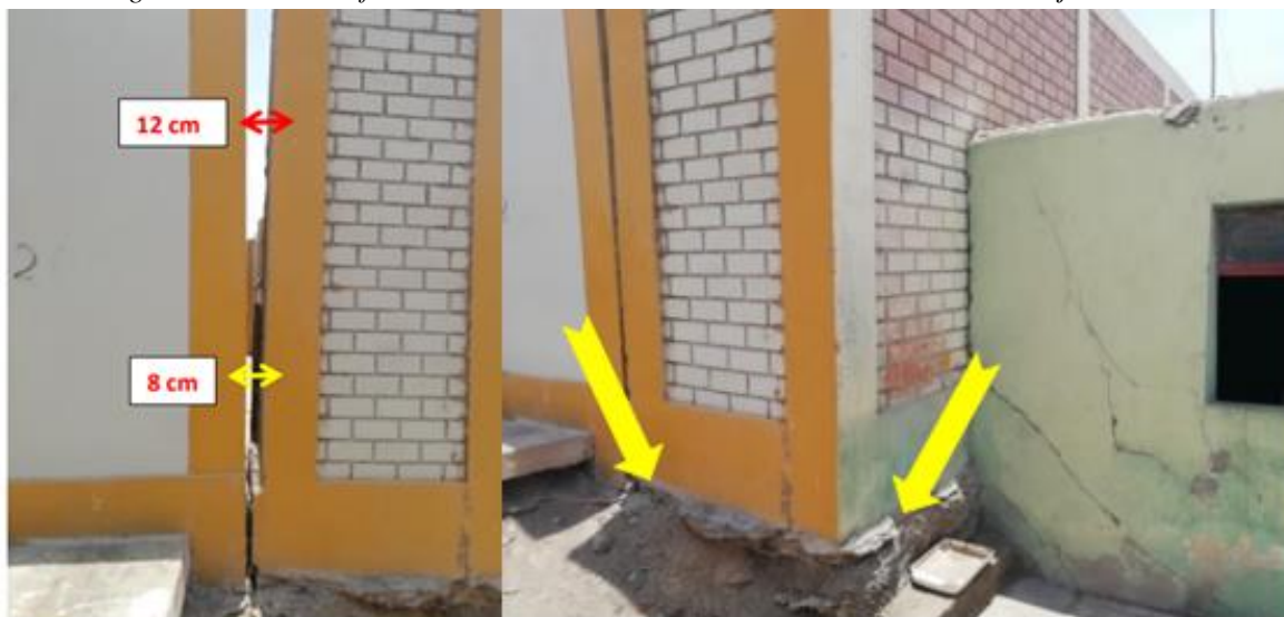
Figura N° 3-41: Verificación del daño in-situ con el contratista al inicio de la ejecución.
