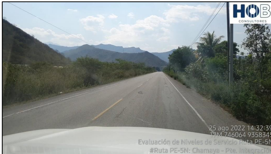
Figura N° 17 -Fotograma de Incidencia (Fisura > 3mm) con el Software APP
