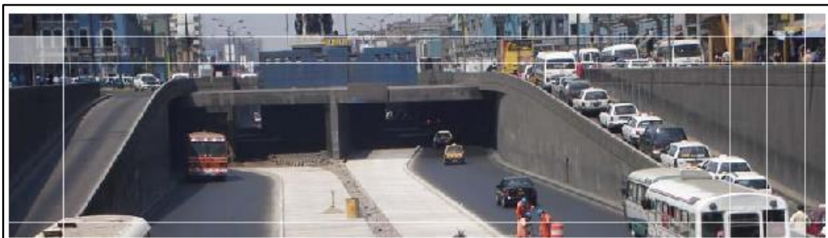
Figura N° 4 - Supervisión de la Construcción del Corredor Segregado de Alta Capacidad COSAC I (Corredor Troncal del Metropolitano)
