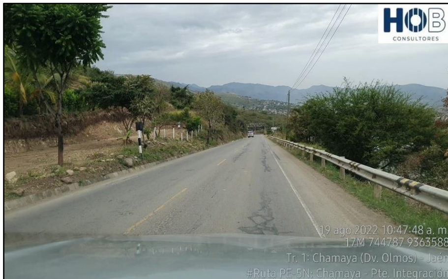
Figura N° 48 - Indicador de Fisuras > 3mm del Km. 12+700 al Km. 12+800
