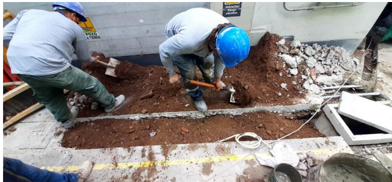
Figura 31: Conexionado de red de desagüe
