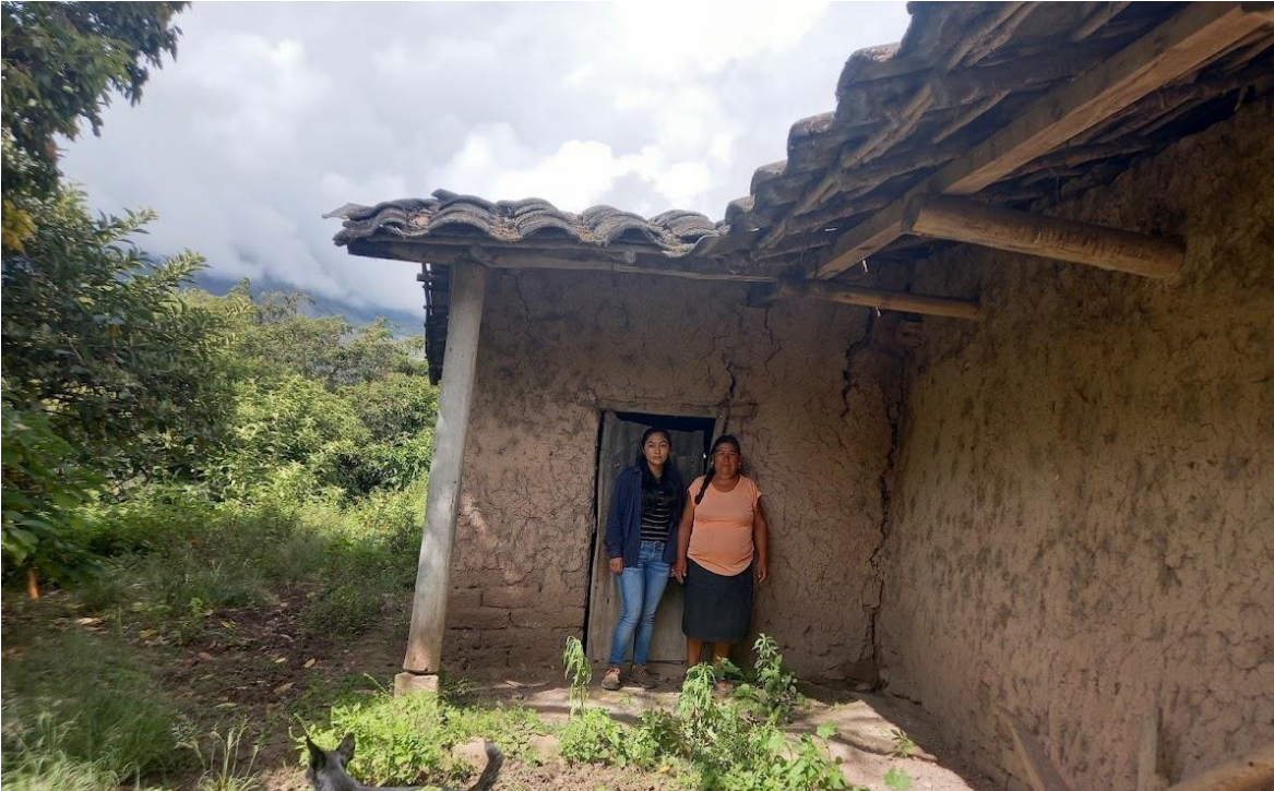
Foto N.º 5: Vivienda (3) de adobe presenta agrietamientos ( falla por cortante de muro).
