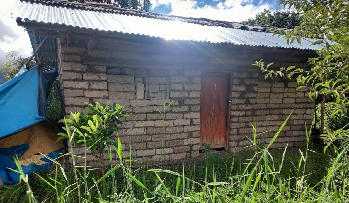
Foto N.º 3: Vivienda (1) de adobe de un piso sin ningún tipo de refuerzo; así mismo, hacen uso de madera y calamina como cobertura de techos.
