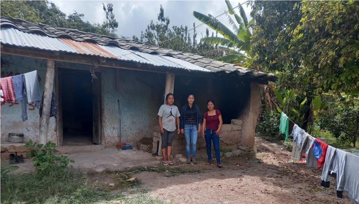
Foto N.º 7: Vivienda (5) de un piso a base de adobe presenta algunos agrietamientos en los muros.
