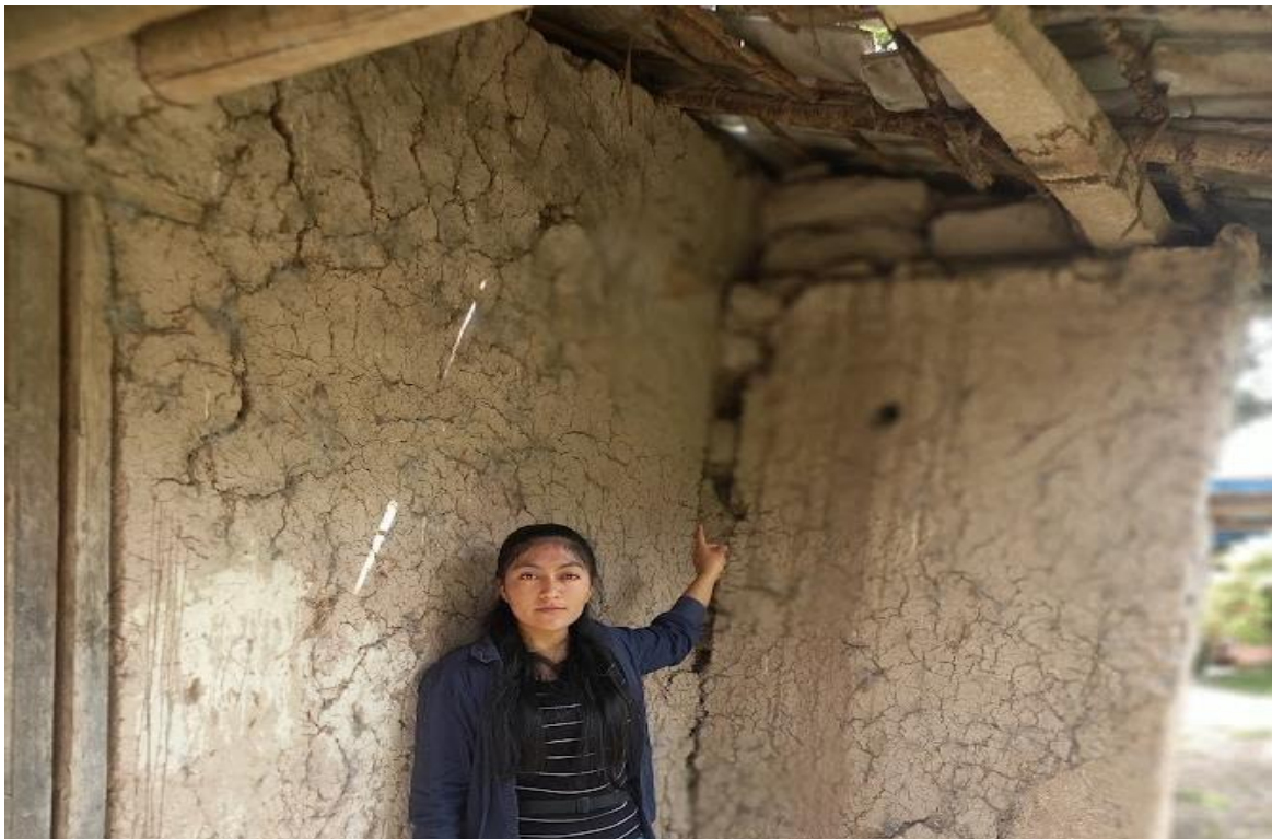
Foto N.º 12: Falla en los muros, se aprecia que no existe una unión correcta de muros.
