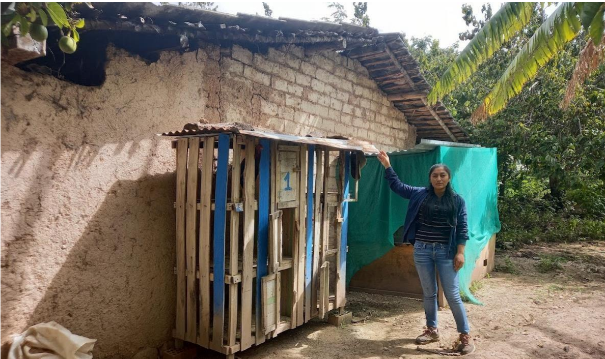
Foto N.º 6: Vivienda (4) de adobe presenta agrietamientos ( falla por cortante de muro).
