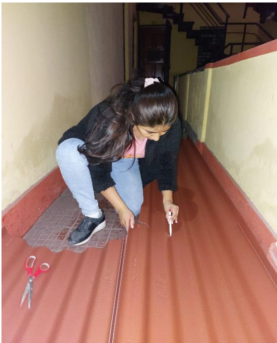
Nota: Construcción de la estructura para el prototipo de techos verdes en bandejas livianas.
