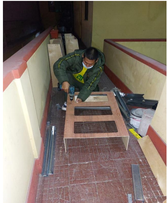
Nota: Construcción de la estructura para el prototipo de techos verdes en bandejas livianas.
