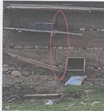
Fisura en muro
