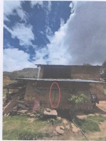
Fisura en muro
