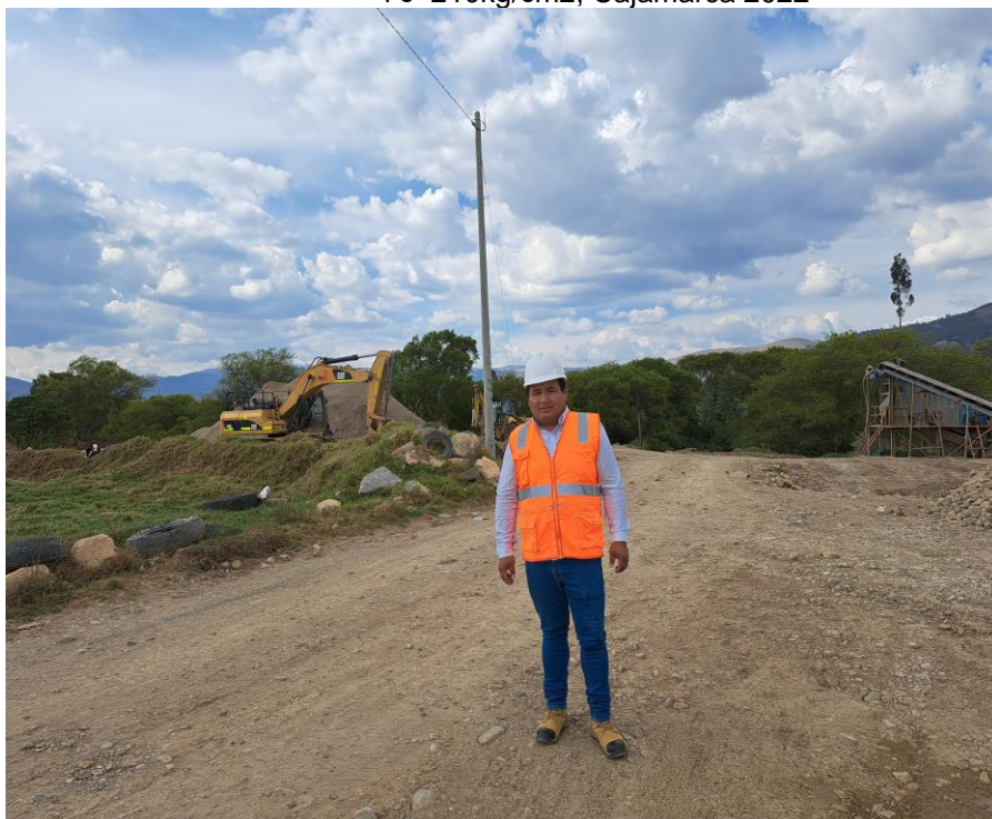
Fotografía N° 5: en la cantera hermanos Alaya la victoria en el área de despacho de los agregados.
