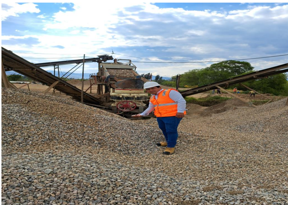
Fotografía N° 2: verificando la calidad de la grava de 3/4” y de 1/2” en la cantera la victoria.
