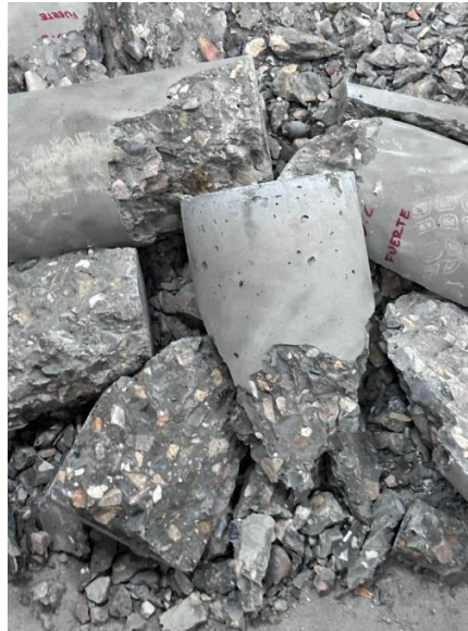
Figura 15. Rotura de los especímenes de concreto.
